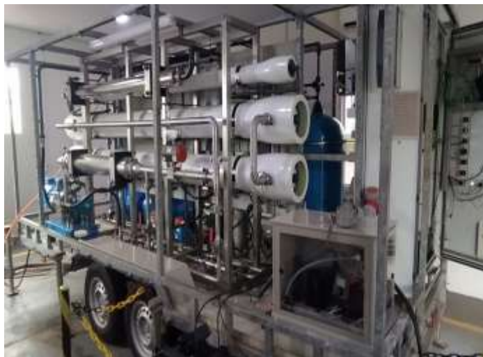
Figura 9 – Unidade Compacta de osmose reversa para tratamento de chorume.
