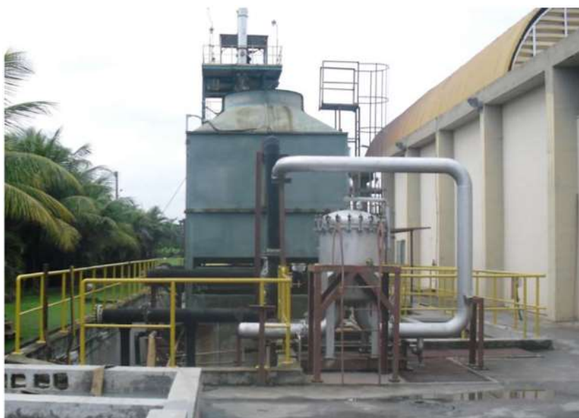
Figura 11 – Vista geral dos equipamentos e incinerador da Usina Verde, RJ.
