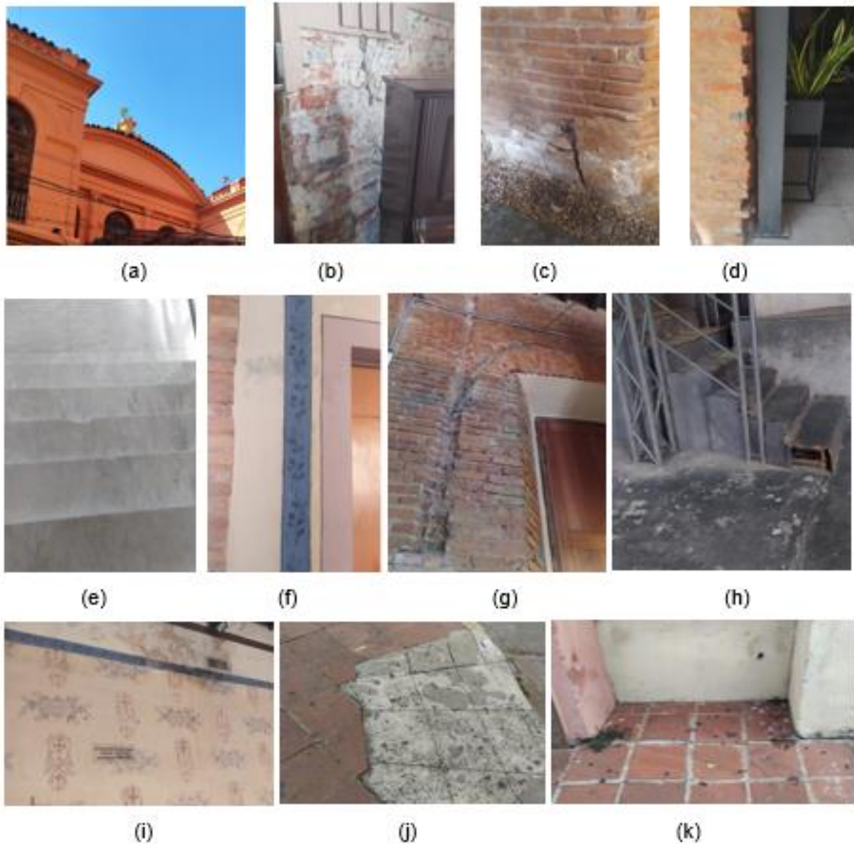
Figura 45: Patologías presentes en el Teatro Municipal Ignacio A. Pane
