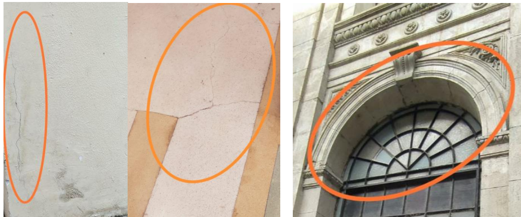
Figura 5: Fisuras en paredes, pisos y ventanas
