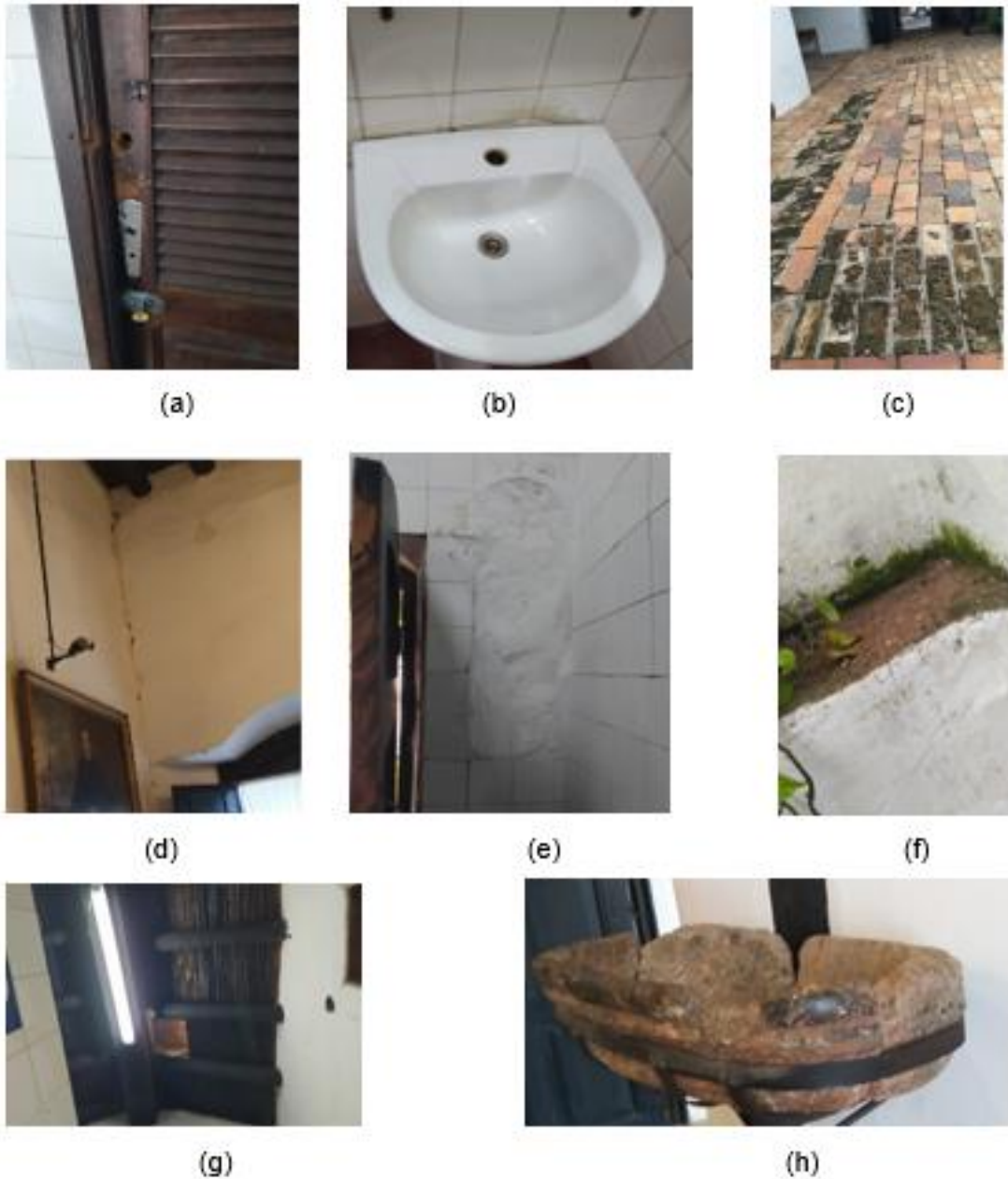
Figura 42: Patologías presentes en la casa de la Independencia
