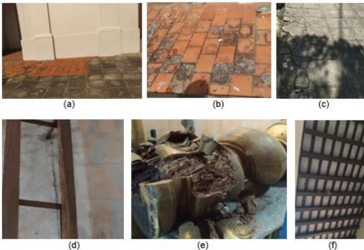
Figura 47: Patologías encontradas en la Iglesia Santísima Trinidad
