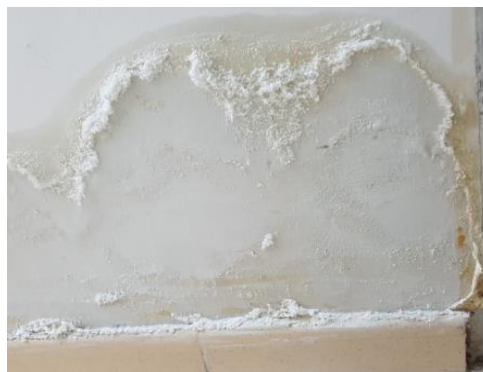
Figura 8: Eflorescencia en paredes
