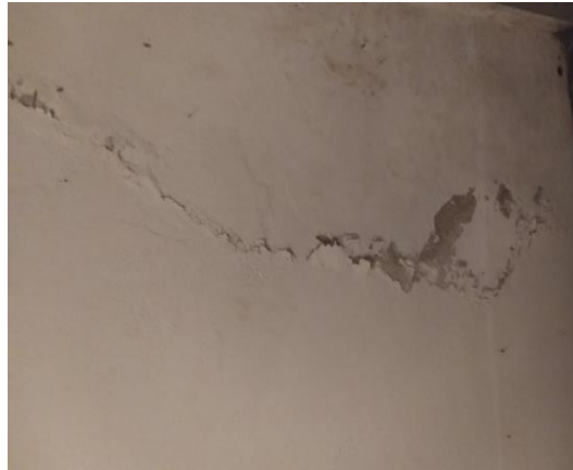
Figura 10: Descamación de pintura
