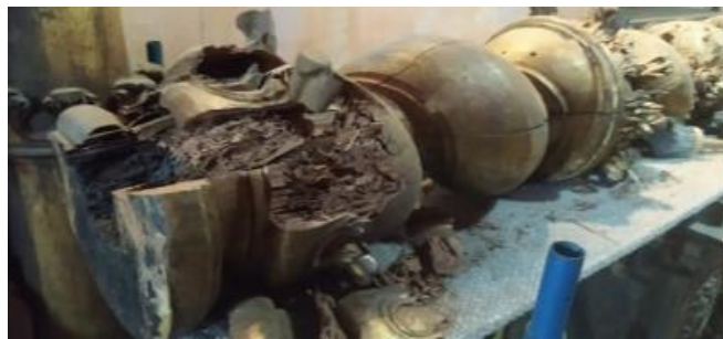
Figura 2: Columna de madera deteriorada
