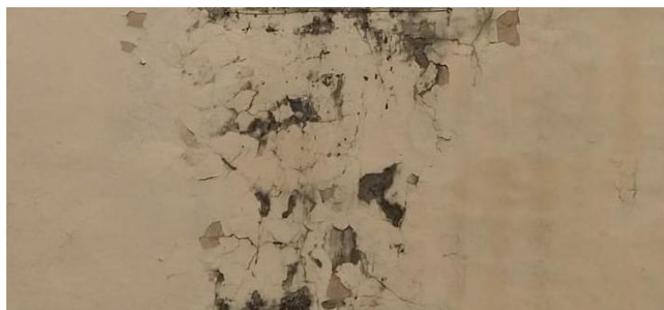
Figura 6: Efecto de humedad en paredes.
