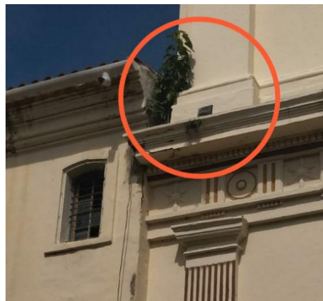
Figura 14: Desarrollo vegetal en las superficies exteriores de las fachadas del edificio
