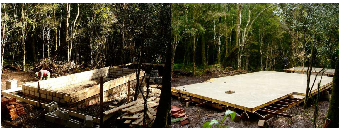
Figura nº 56. Base em bloco de concreto à esquerda, laje em concreto armado à direita.
