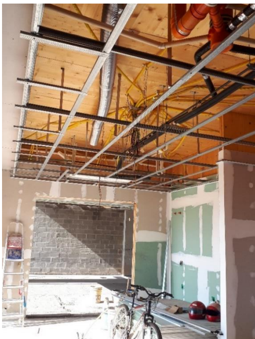
Figura 3.32. Tubulação e fiação embutida no forro de drywall
