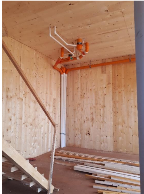
Figura 3.31. Tubulação de esgoto que será embutida em shaft e forro de drywall
