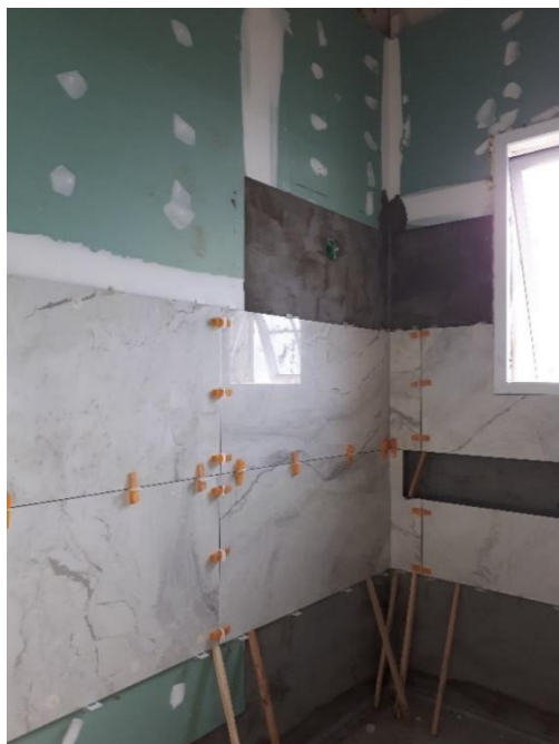
Figura 3.33. Banheiro revestido com placas de drywall resistente à umidade e revestimento cerâmico
