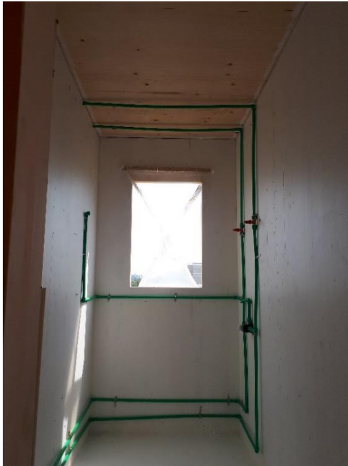
Figura 3.30. Tubulação de água quente e fria do banheiro
