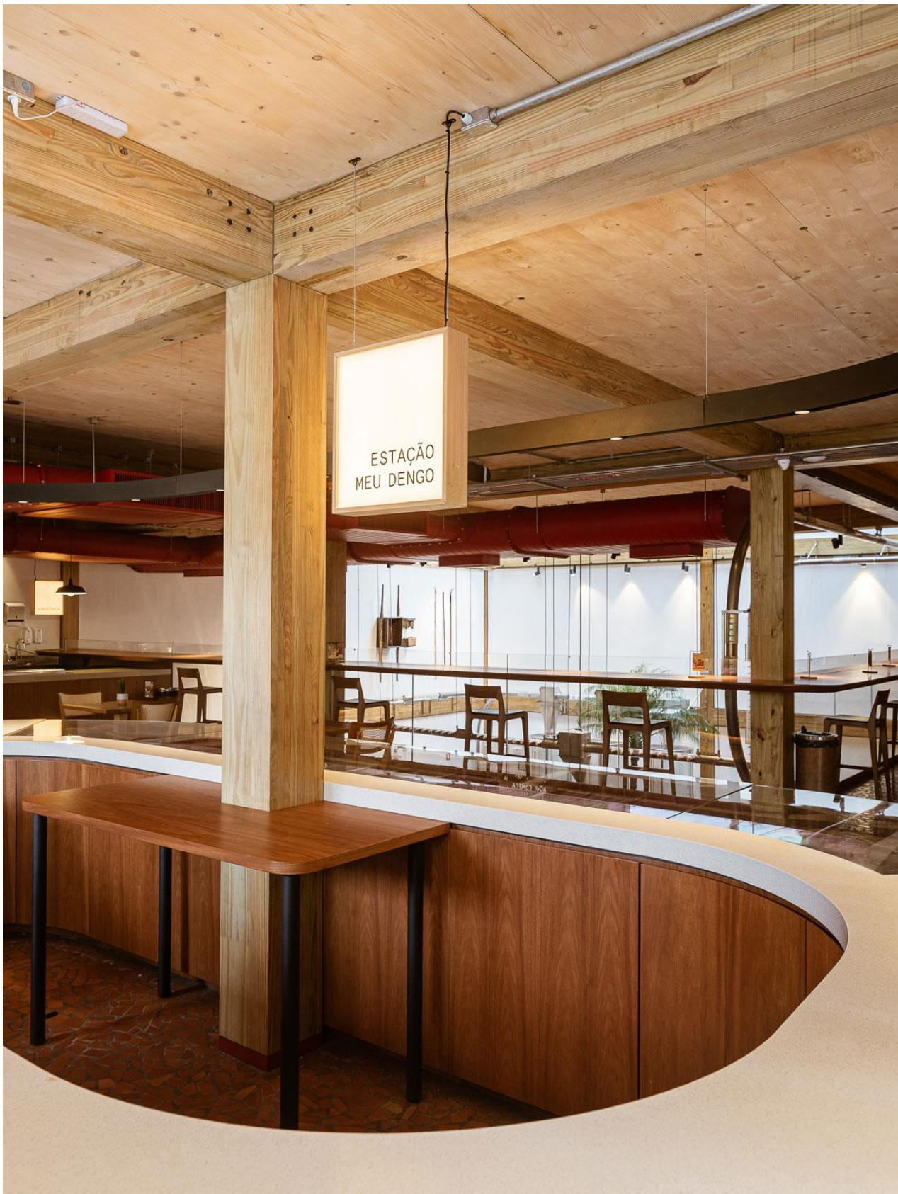
Figura 3.9. Sistema misto com lajes e paredes em CLT e vigas e pilares em MLC
