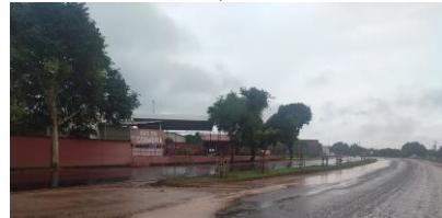
Figura 11. Acúmulo de água no Canteiro leste, no Trecho BC.
