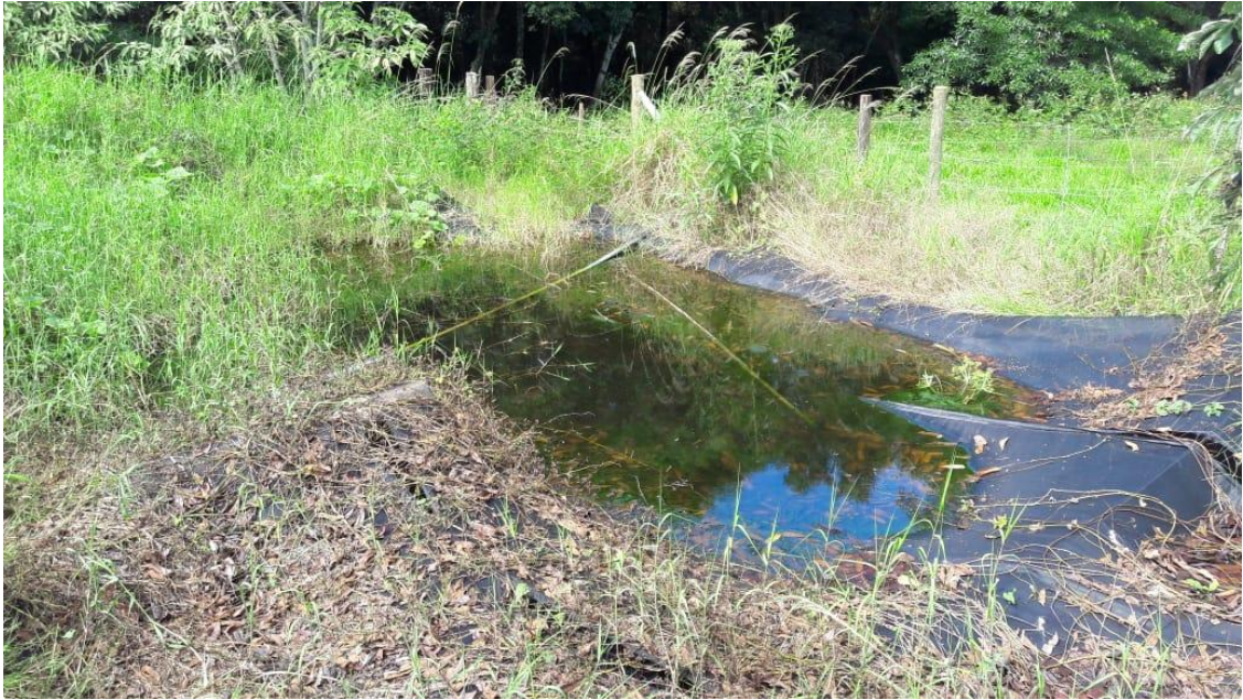
Figura 2 – Biodigestor inoperante instalado na instituição de ensino
