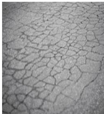
Figura 4. Trincas por fadiga
