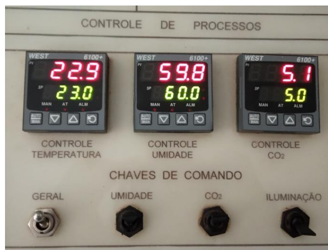
Figura 23: Painel de controle da câmara climatizada
