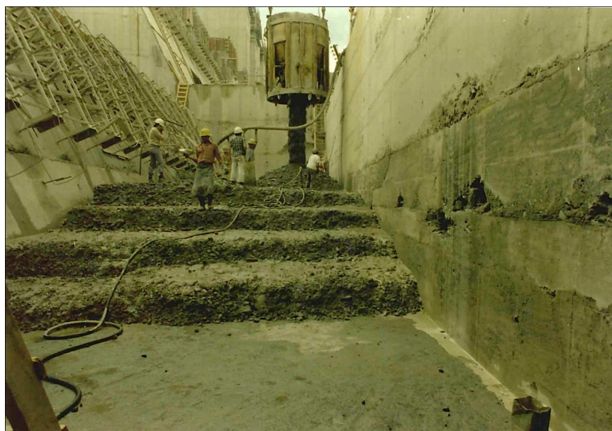
Figura 19 – Ninhos de concretagem na face montante do concreto de enchimento.
