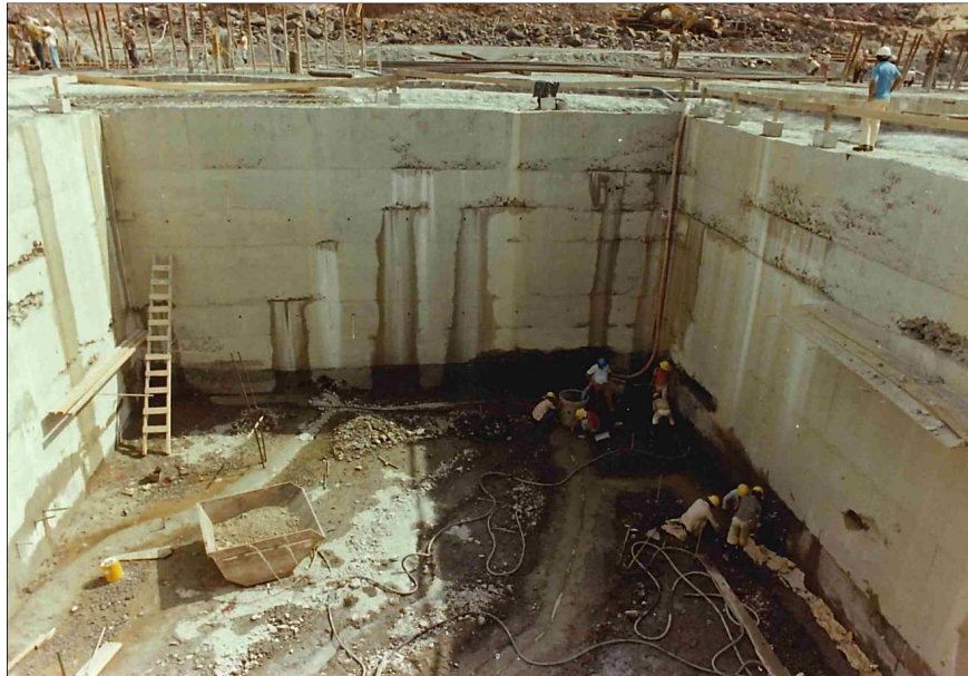
Figura 18 – Ninhos de concretagem no interior de um poço.
