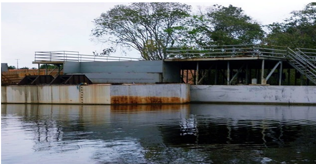
Figura 19 - Obra inacabada do terminal municipal de Barcelos.
