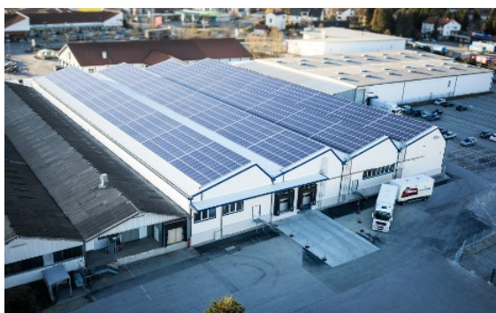
Figura 6 – Instalação fotovoltaica com aproveitamento da área de telhados disponível
