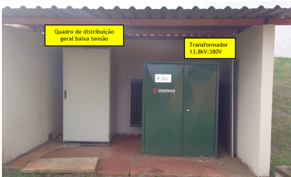
Figura 21 – Casa do transformador
