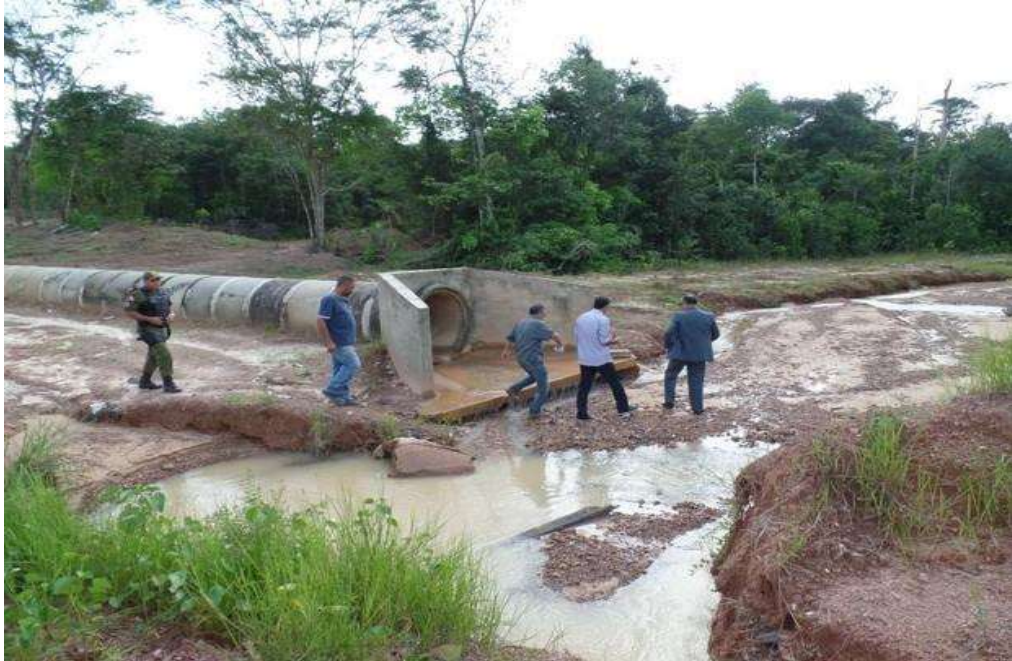
Figura 10 – Esgoto despejado no igarapé fronteiro à comunidade de Abacatal
