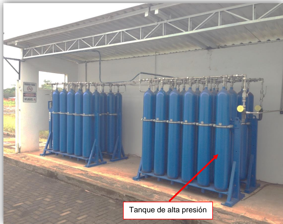
Figura 22: Vista general de los tanques de alta presión.
