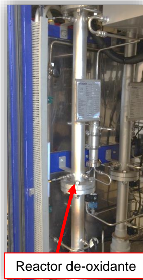
Figura 16: Vista general del reactor de-oxidante.
