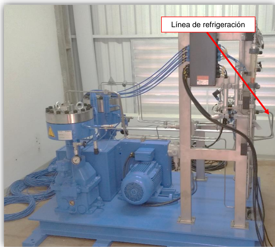
Figura 21: Vista general del compresor.
