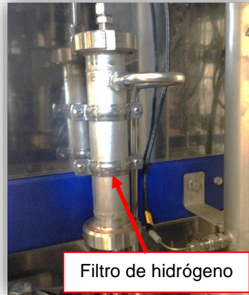
Figura 17: Vista general de filtro de hidrógeno.
