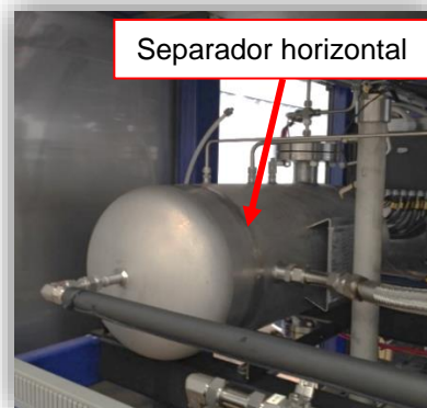
Figura 11: Vista general del separador horizontal de gas.
