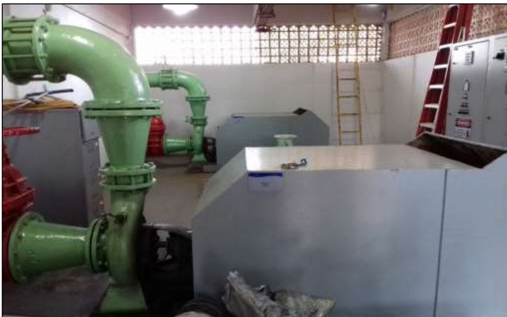
Figura 9 - Estação elevatória EET03
