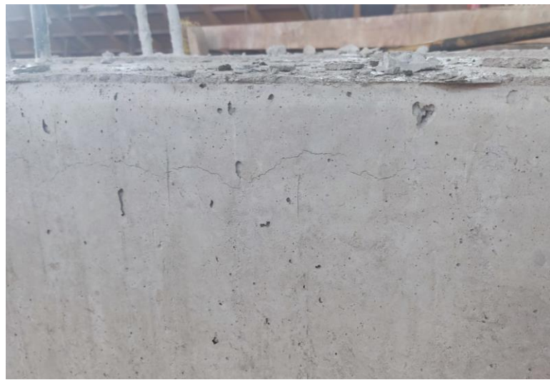
Figura 8 - Peça com trinca de retração
