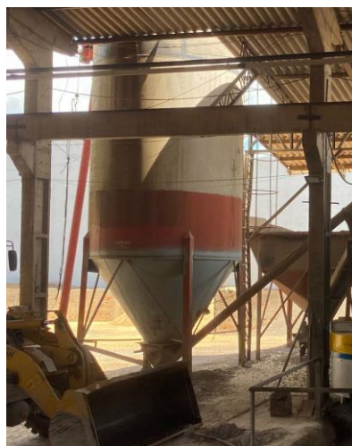
Figura 3 - Silo de cimento
