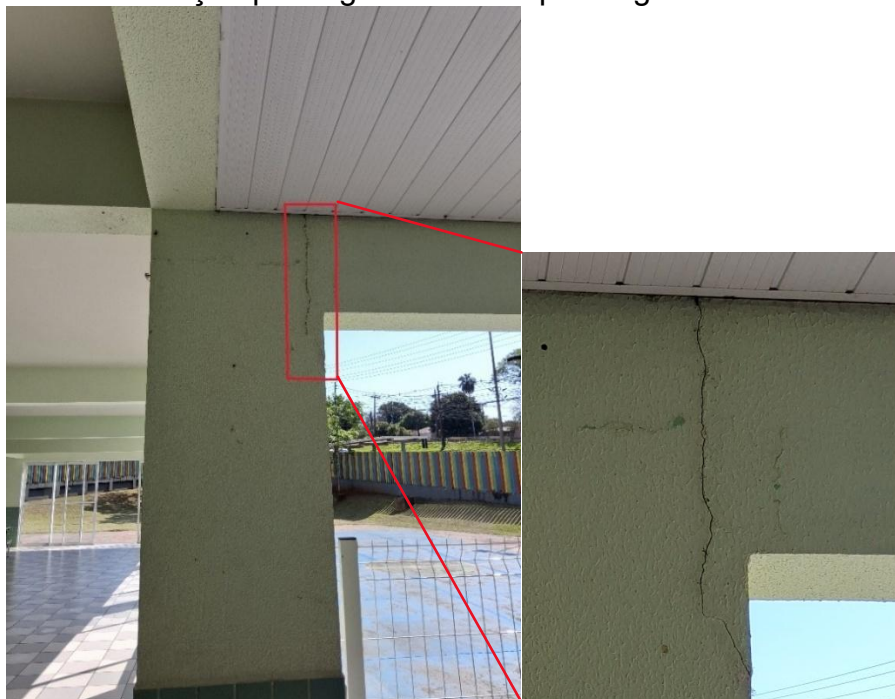
Figura 35 – Manifestação patológica interface pilar-viga PV 07 e detalhe de trinca
