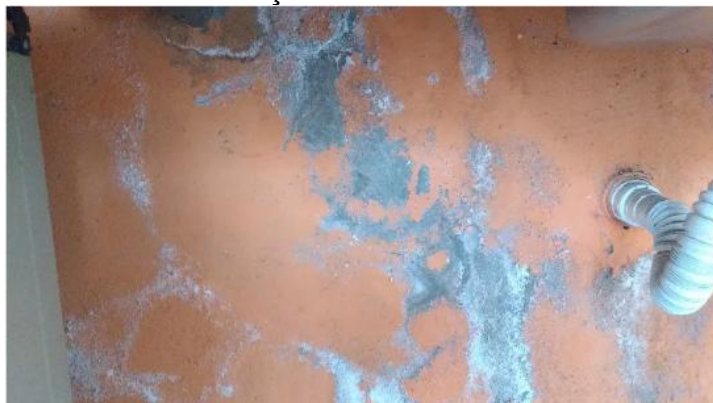
Figura 19 – Manifestação de eflorescência em edificação.
