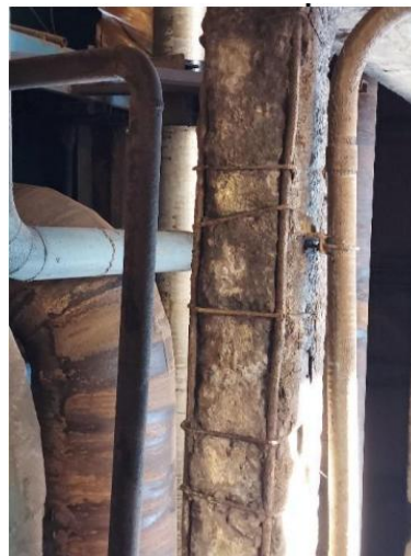
Figura 3 – Processo de corrosão em pilar
