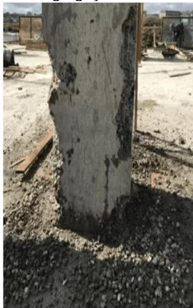
Figura 2 – Desagregação do concreto em pilar
