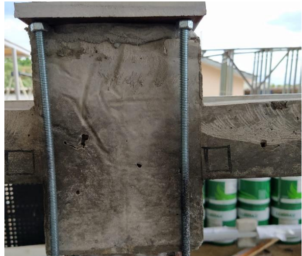
Figura 42 – Viga degradada com umidade após a retirada da membrana geotêxtil.
