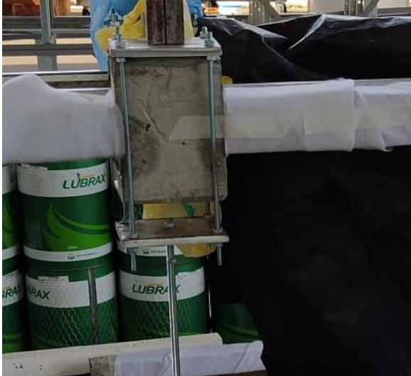
Figura 41 – Viga degradada apresentando umidade na região do console antes do processo de aspersão.
