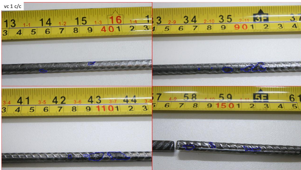
Figura 90 - áreas superficiais corroídas do vergalhão da viga vc 1 c/c – parte 1
