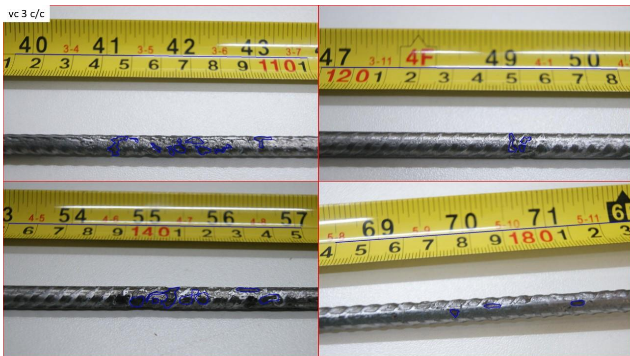
Figura 95 - áreas superficiais corroídas do vergalhão da viga vc 3 c/c – parte 2
