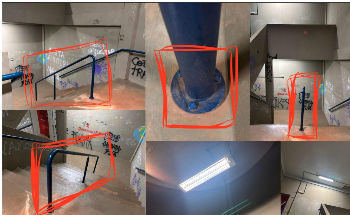
Figura 106 – Alterações necessárias na escadaria
