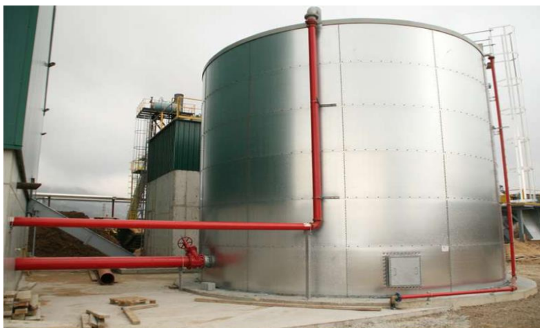
Figura 8 – Silo de armazenamento.
