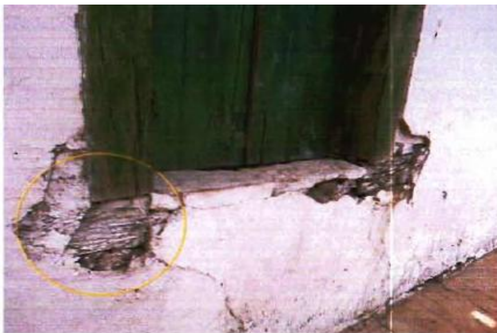
Figura 11 - Janela deteriorada na propriedade
