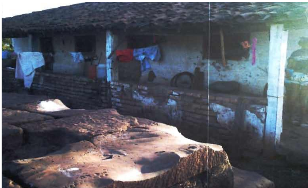
Figura 9 - Área molhada com pedra para lavar roupa e varanda sendo utilizada para estender roupas em estado deteriorado
