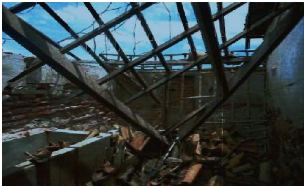
Figura 10 - Telhado desmoronado no cômodo próximo à cozinha da Fazenda
