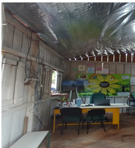
Figura 5 – Fiação exposta em ambientes educacionais
