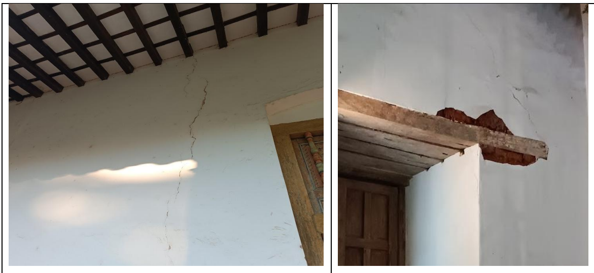
Figura 76. Manifestación patológica en muros
