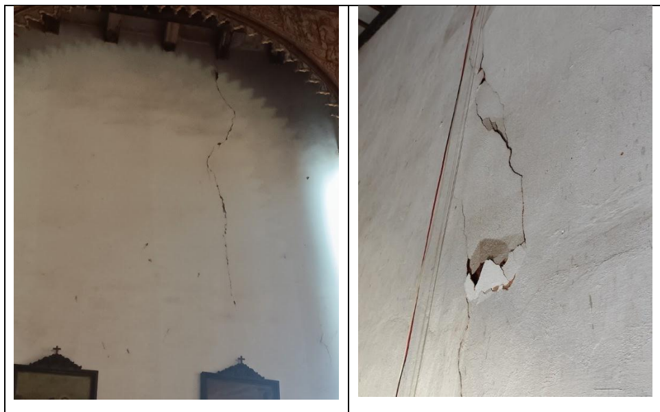
Figura 79. Manifestación patológica de fisuras superficiales en revoques
