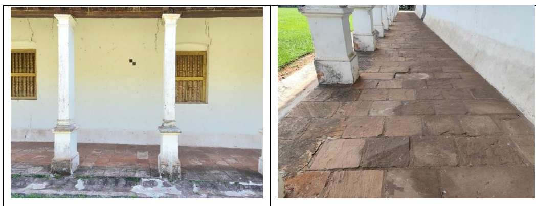
Figura 82. Manifestación patológica humedad
