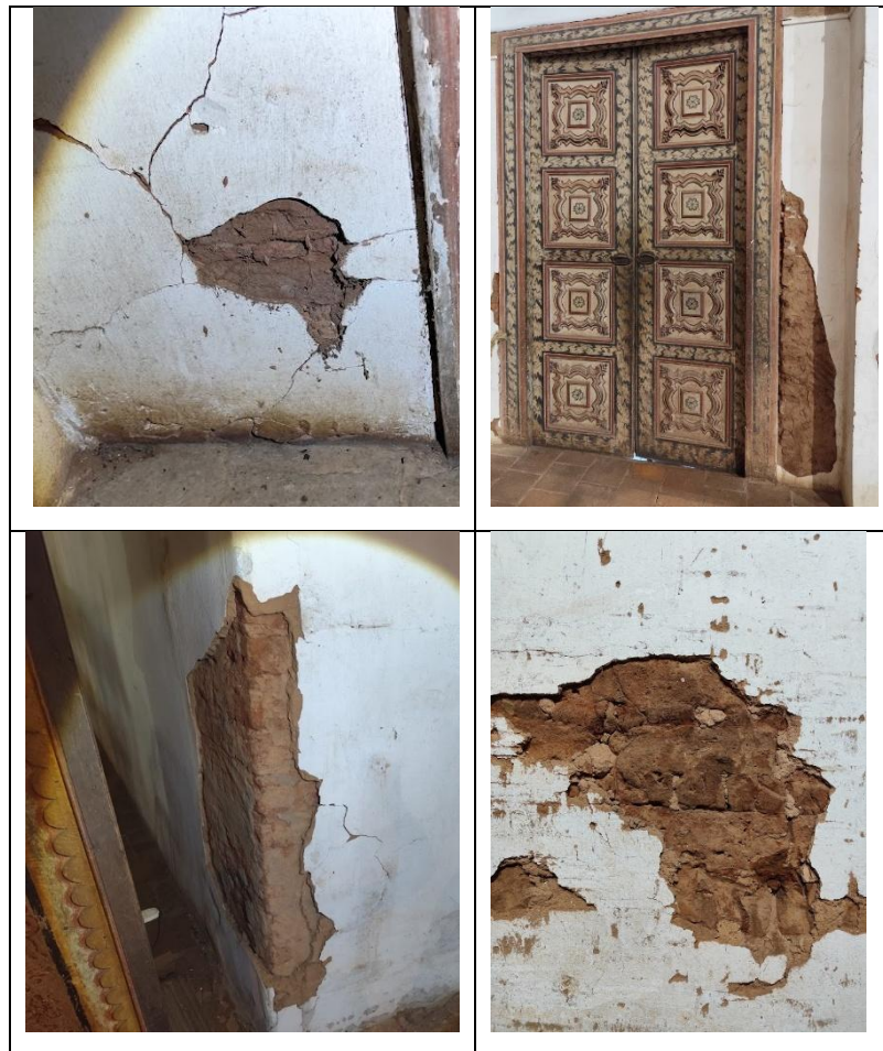
Figura 80. Manifestación patológica de desprendimiento
