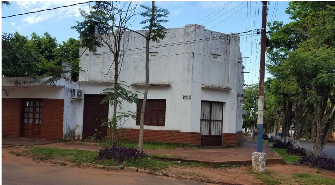
Figura 39: Estado actual, del edificio, Vivienda familia Centeno.
