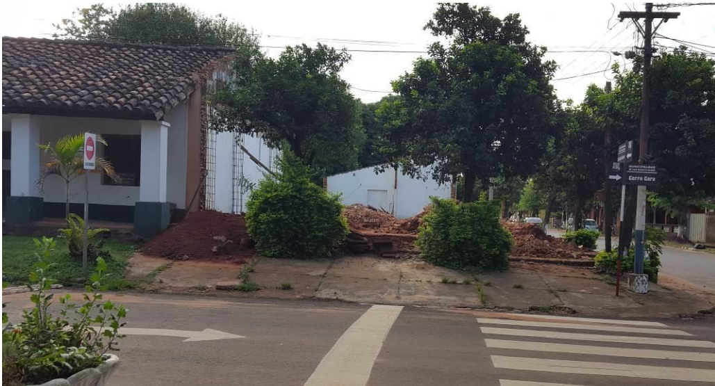
Figura 3: Estado actual Inmueble demolida en su totalidad, nótese que esta siendo preparado armaduras para pilar de contrato
