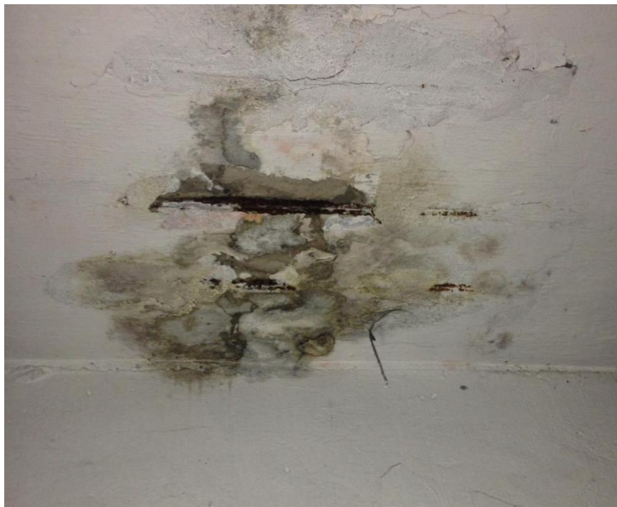
Figura 2 – Laje parcialmente deteriorada devido a corrosão por carbonatação.
