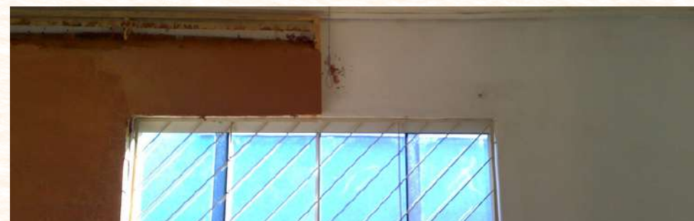
Figura 103 - Imagen térmica del muro el 18 de julio a las 16:00h. Fuente: imagen propia
