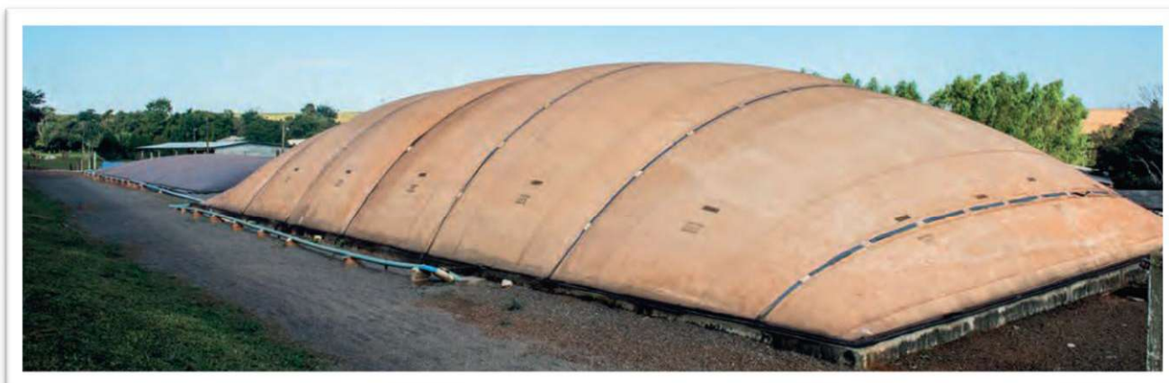
Figura 8 - Biodigestor de lagoa coberta
