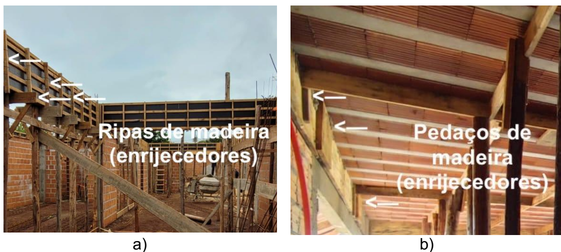
Figura 12 – Sistema de enrijecedores: a) ripas utilizadas como enrijecedores de vigas; b) sobras de recortes de madeira usadas como enrijecedores de vigas
