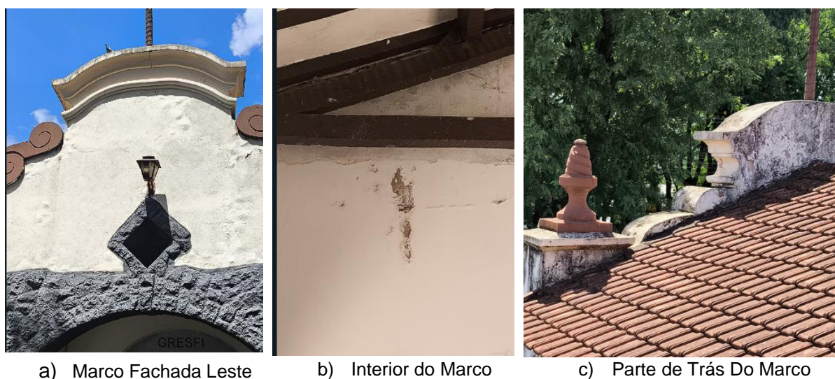
Figura 41: Absorção de Água Na Parede da Fachada
