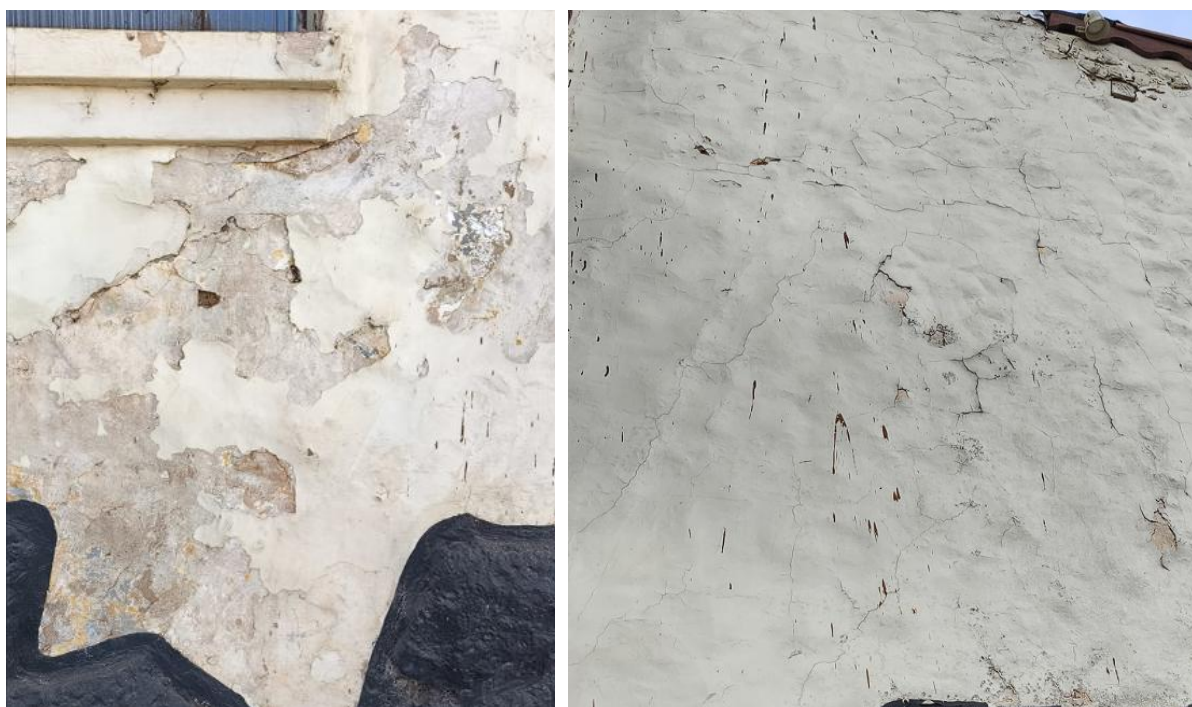
Figura 28: Destacamento de Pintura
