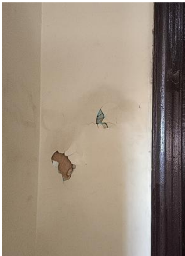
d) Desplacamento de revestimento
