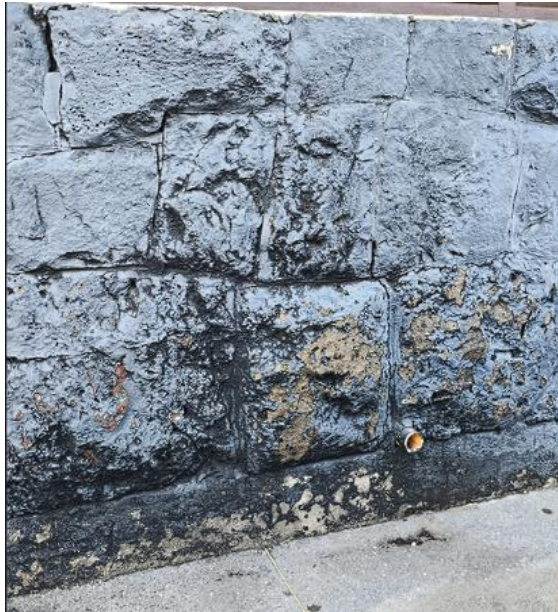
a) Capilaridade na Camada de Pintura
