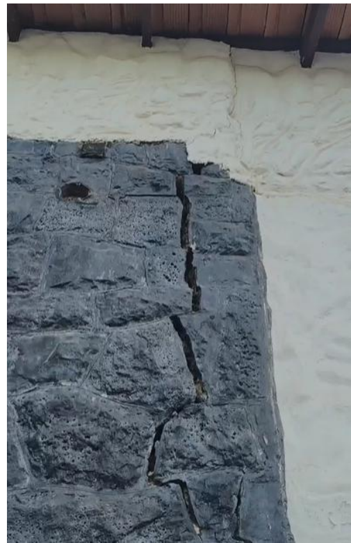
b) Fissuração na Parte Superior a Porta
