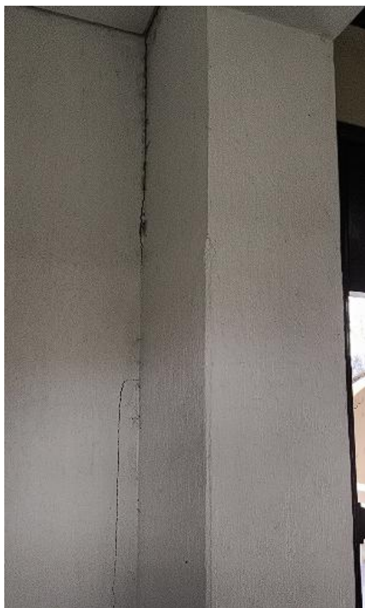
c) Fissuração por cisalhamento e tração de alvenaria
