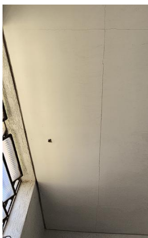
Figura 45: Fissuração Entre as Juntas Do Teto
