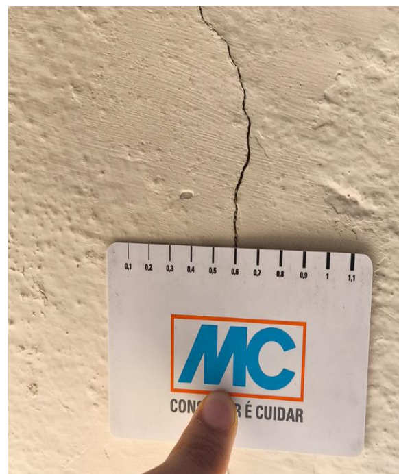
d) Abertura de Fissuras de 0,6mm
