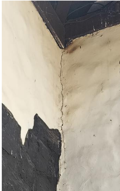
Figura 8: Fissuração Entre as Alvenarias Devido à Falta de Amarração
