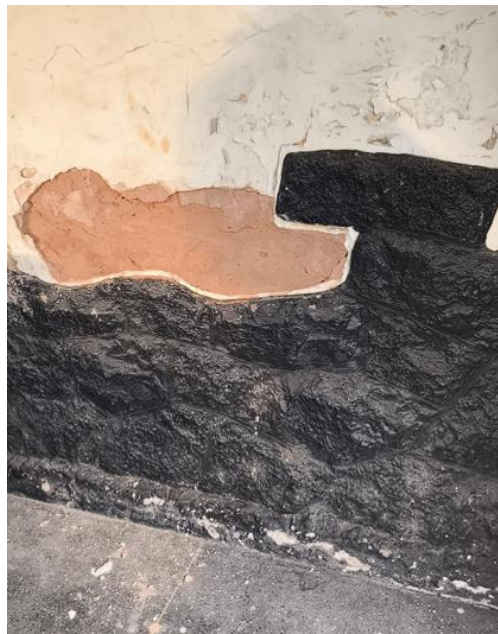
Figura 29: Deslocamento de Placas de Rochas
