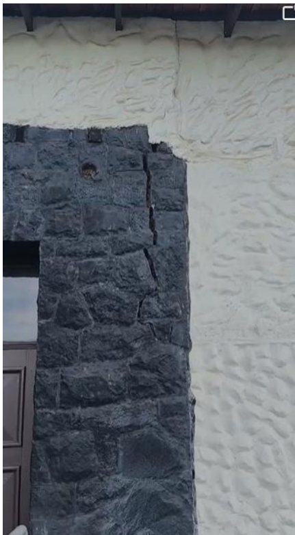
a) Fissura em Marco de Rochas.
