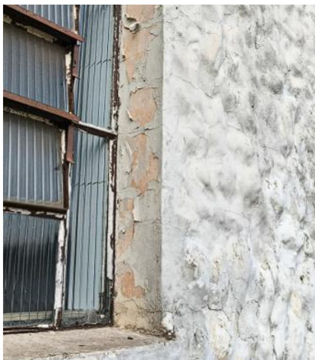
Figura 6: Deterioração de Pintura
