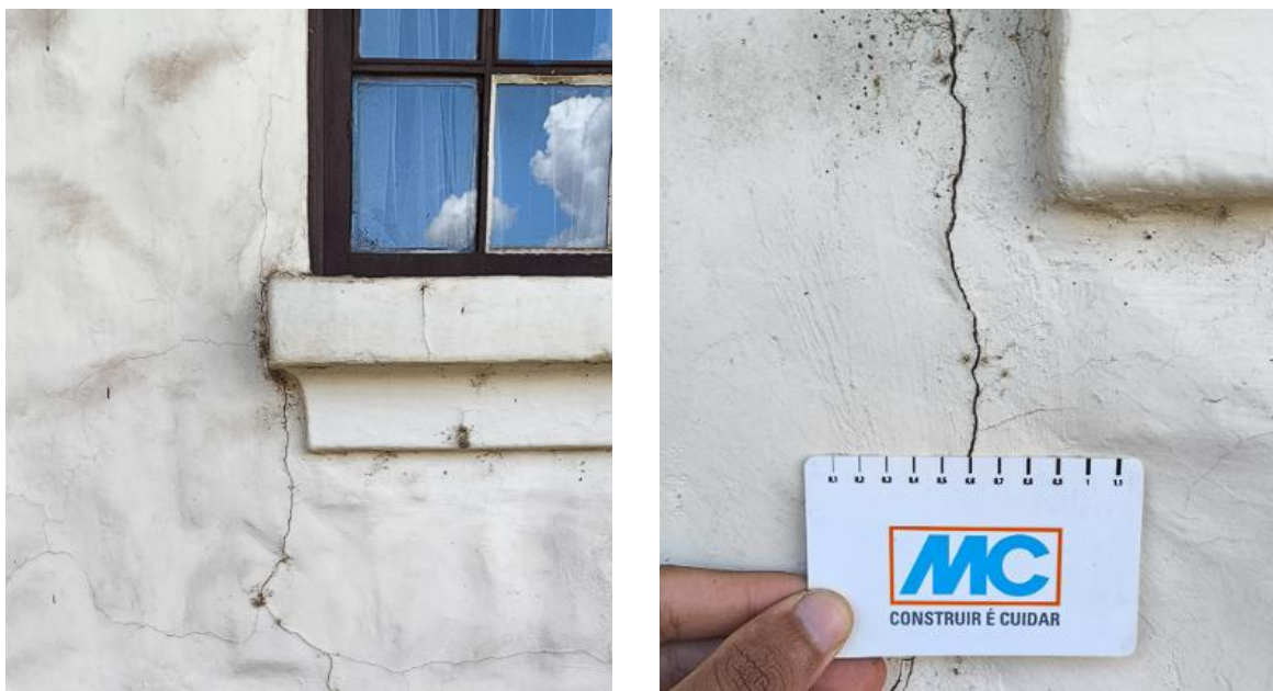
a) Falha de execução de contra verga
