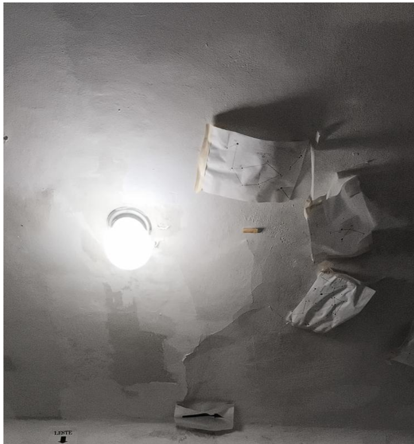
Figura 46: Fissuração em Lajes
