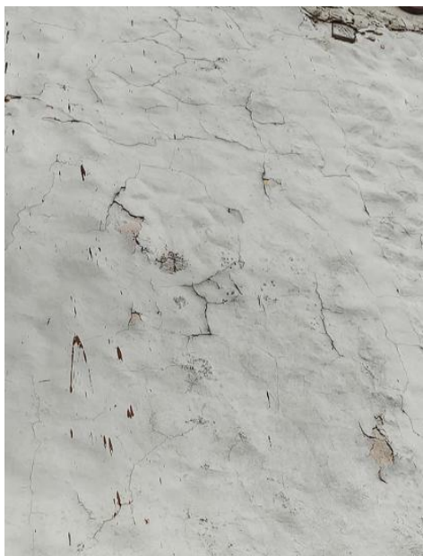
Figura 1: Fissuração Térmica em Alvenaria
