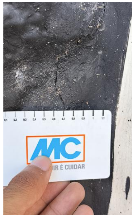
b) Abertura de fissuras de 0,7 mm
