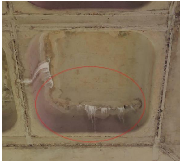
Figura 5: Eflorescência em Laje Nervurada
