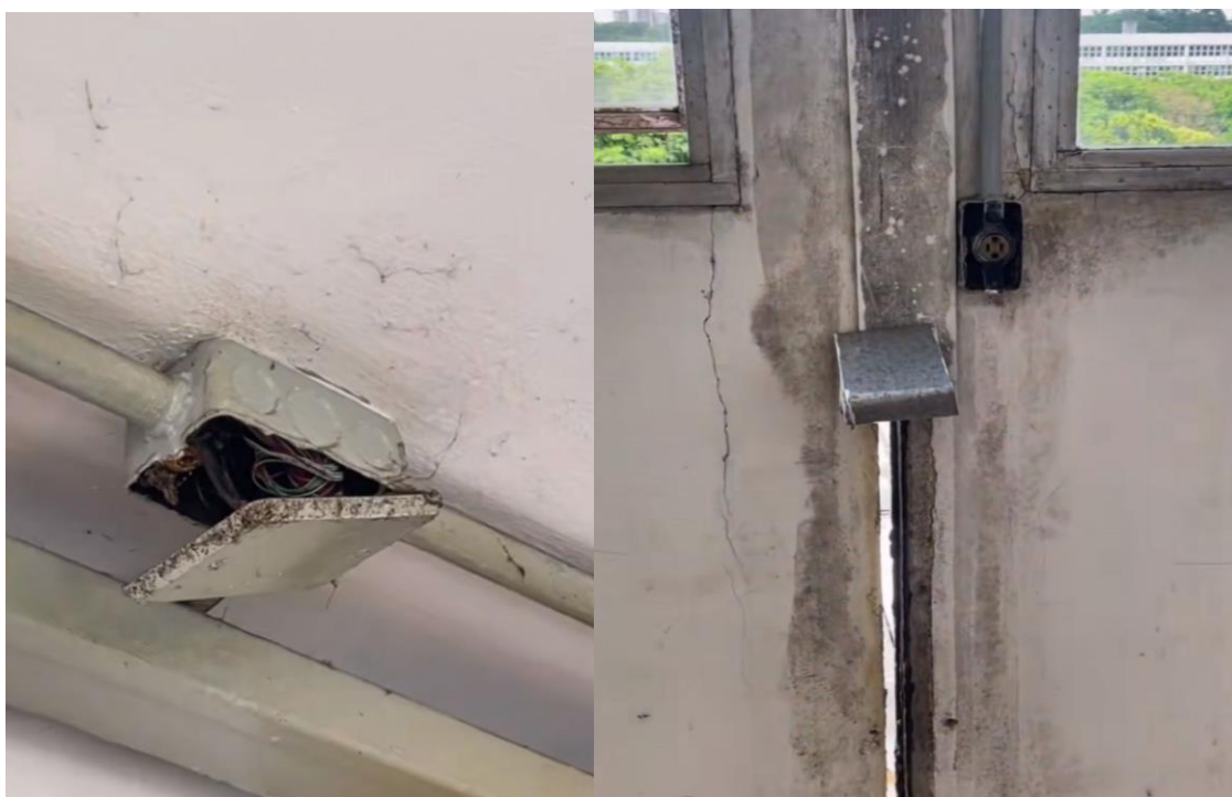
Figura 27 - Fiação exposta, e estrutura sem manutenção.
