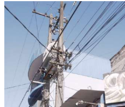
Figura 174. Poste de Transformador de energía. Fuente: Autoría propia 2021
