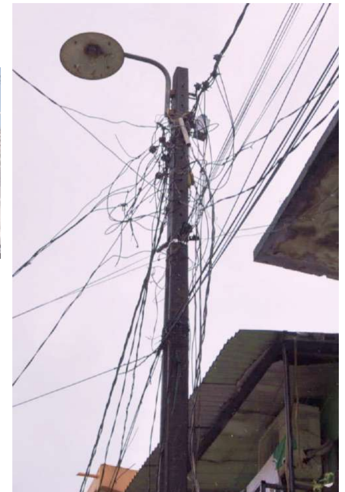
Figura 176. Poste de energía eléctrica y alumbrado público. Fuente: Autoría propia 2021
