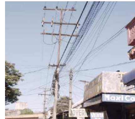
Figura 172. Poste de energía eléctrica. Fuente: Autoría propia 2021
