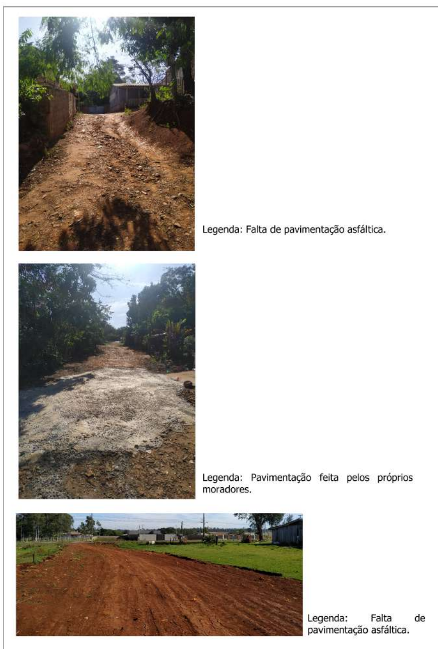
Figura 15: Ruas sem pavimentação.
