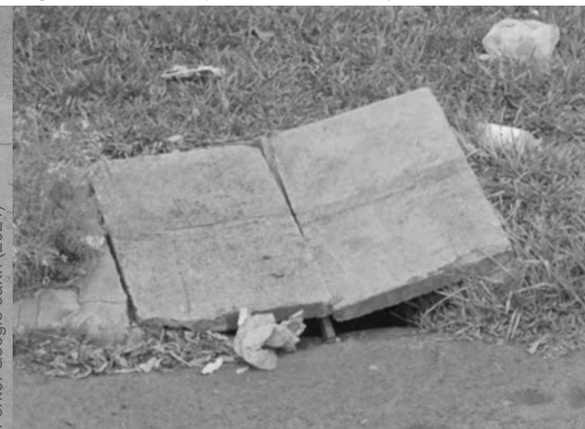
Figura 13: Bueiro entupido. Avenida Tambaqui
