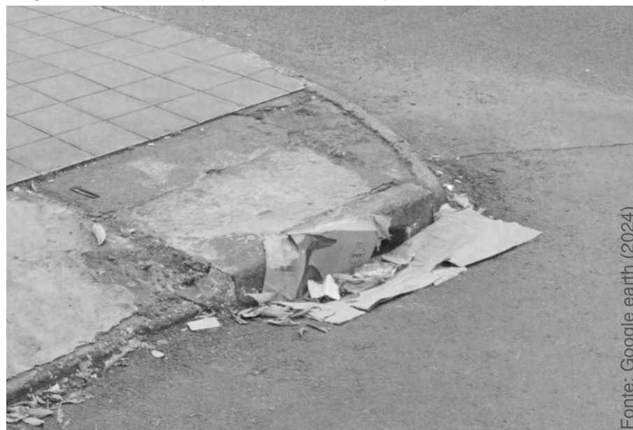
Figura 12: Bueiro entupido. Avenida Tambaqui
