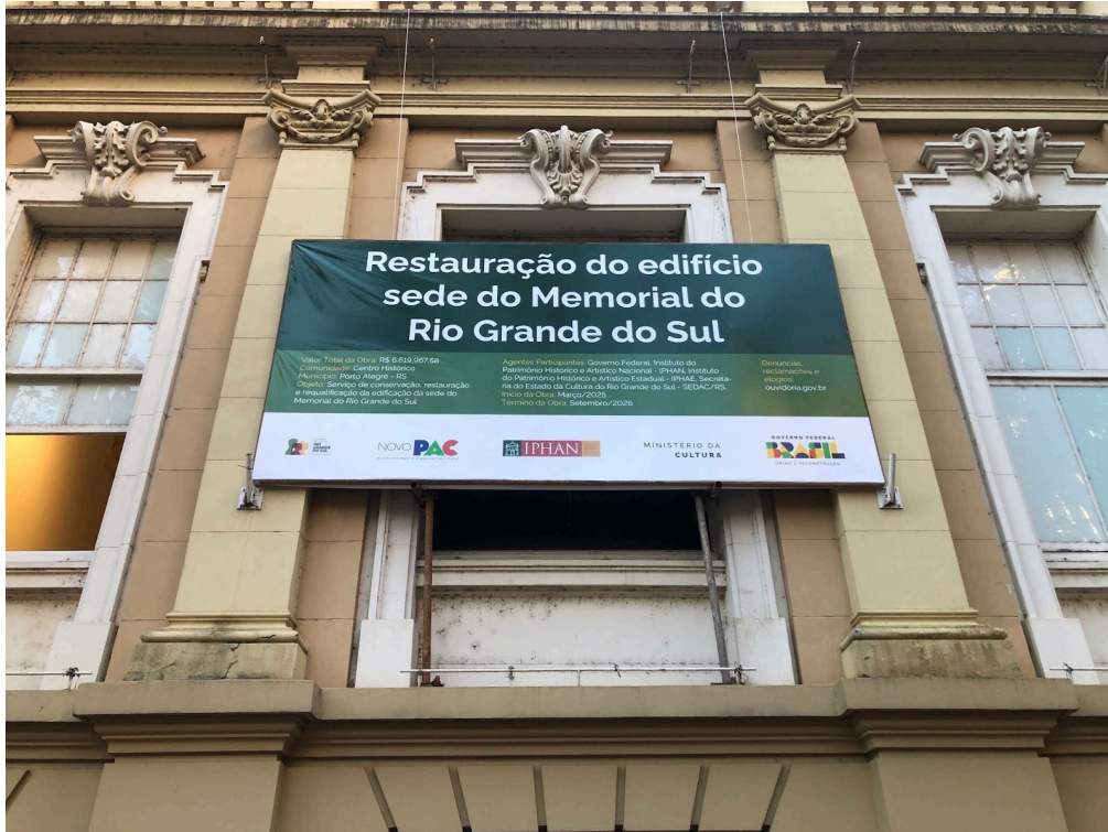
Figura 26: Placa indicando obras de restauração na fachada do Memorial do Rio Grande do Sul, abril de 2025.
