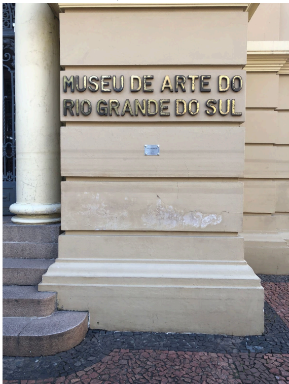
Figura 23: Marcas de infiltração na fachada do MARGS, outubro de 2024.
