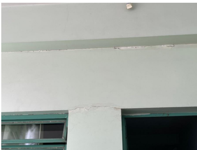
Figura 43 – Detalhe fissura na alvenaria entre aberturas
