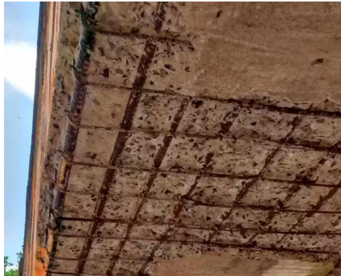
Figura 15 – Corrosão da armadura
