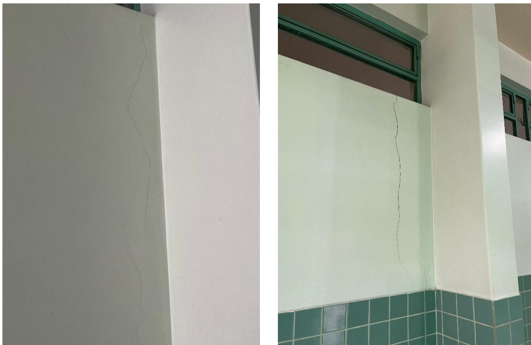
Figura 27 – Fissuras nas aberturas do pavimento superior
