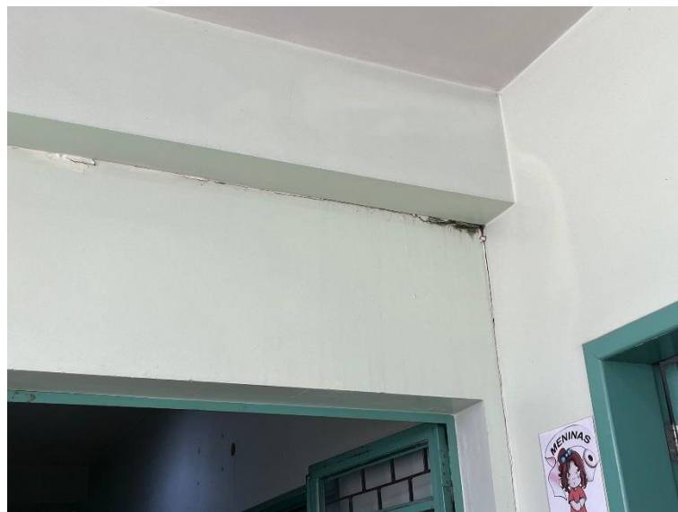
Figura 45 – Fissura, mancha de umidade e fungo
