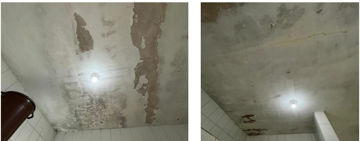
Figura 21 – Manifestações patológicas na laje do pavimento superior
