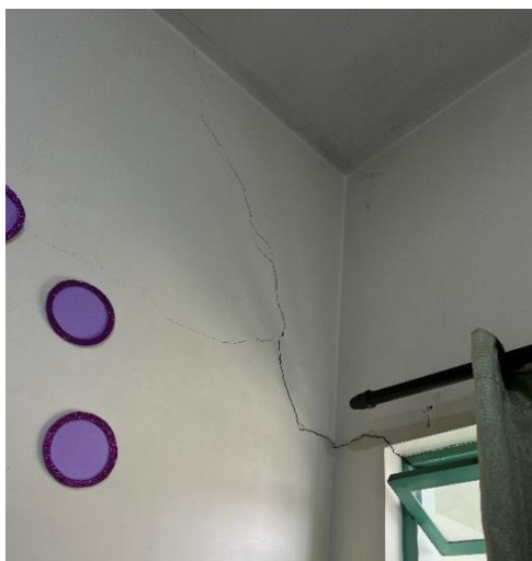
Figura 31 – Fissura acentuada em uma janela do pavimento superior
