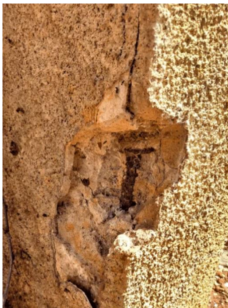
Figura 14 – Desagregação do concreto
