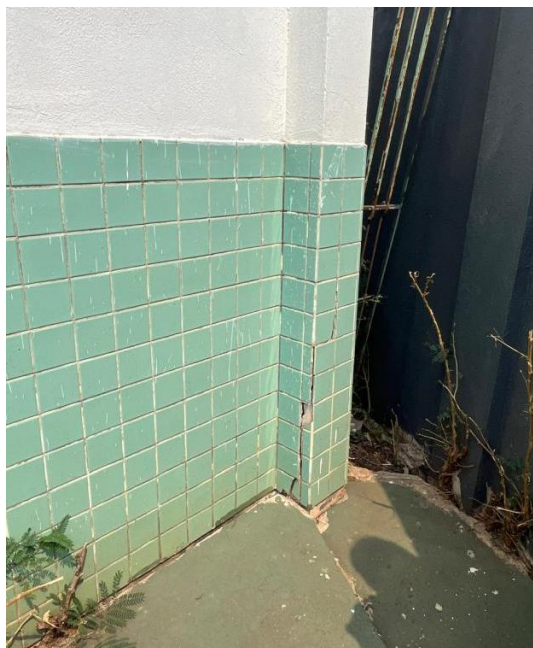
Figura 46 – Fissura na base do pilar de extremidade
