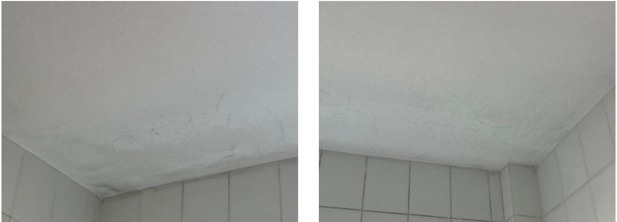
Figura 20 – Manifestações patológicas na laje do pavimento superior
