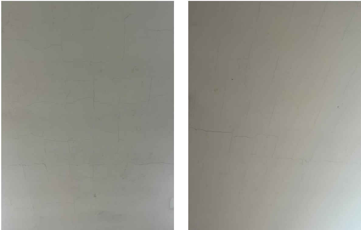
Figura 23 – Fissuras nas lajes do pavimento superior
