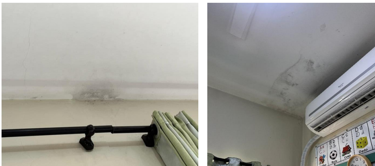
Figura 22 – Manifestações patológicas na laje do pavimento superior
