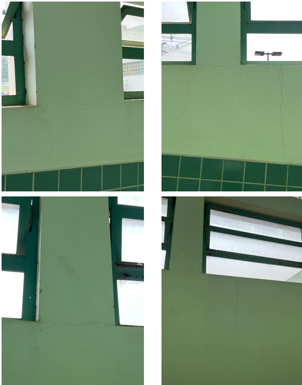
Figura 36 – Fissuras nas janelas da área da rampa
