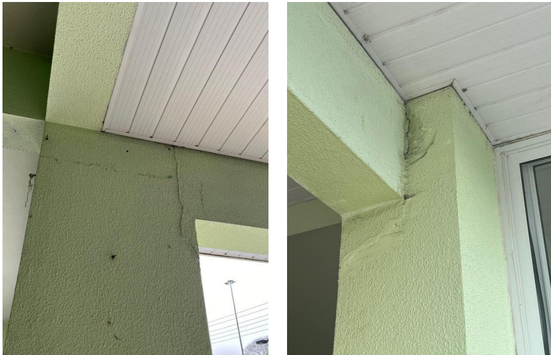
Figura 32 – Fissuras na interface entre viga e pilar
