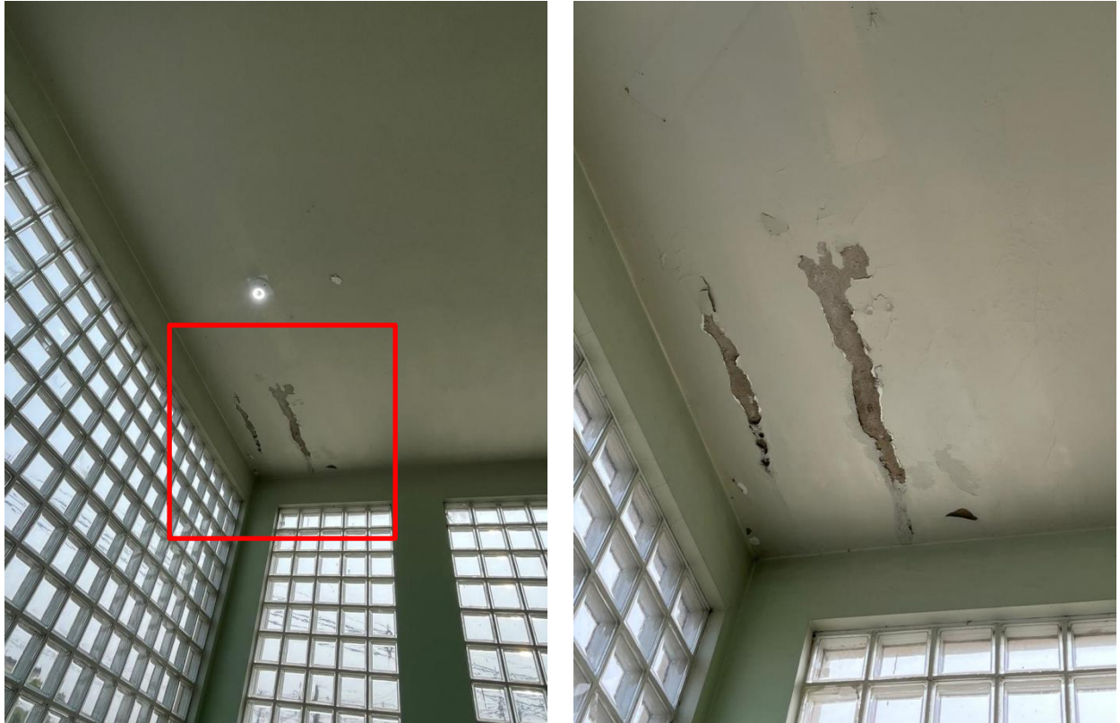
Figura 29 – Manifestações patológicas na laje da área da rampa
