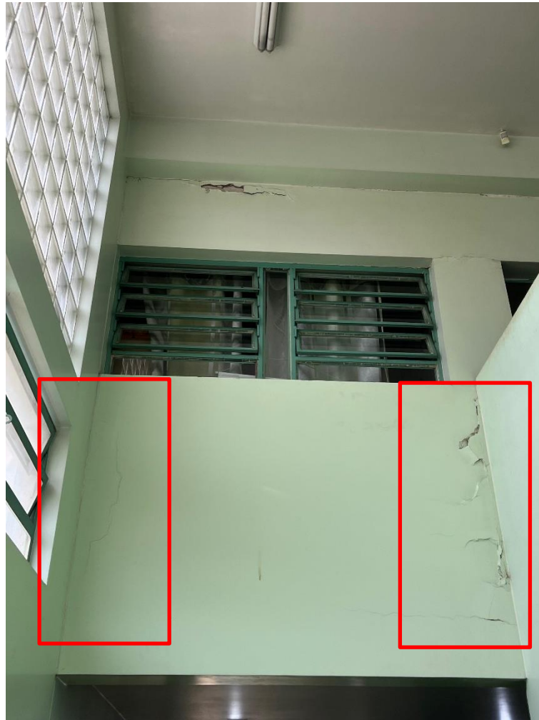
Figura 39 – Manifestações patológicas próximas a junta de dilatação
