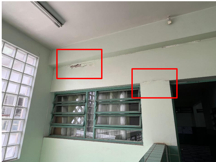
Figura 41 – Fissuras e desagregação do reboco
