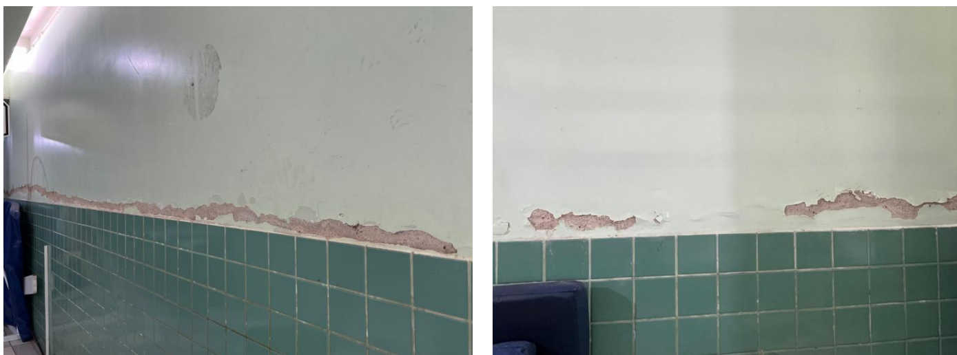
Figura 28 – Manifestações patológicas na lateral da rampa
