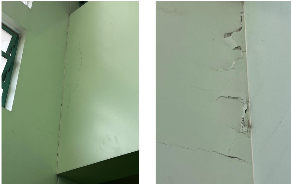
Figura 40 – Detalhe manifestações patológicas próximas a junta de dilatação
