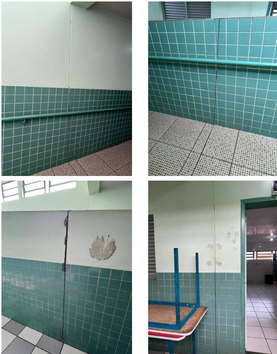
Figura 35 – Deterioração da junta de dilatação
