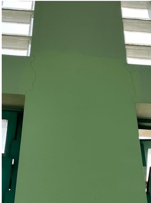
Figura 37 – Fissuras na interface entre viga e pilar
