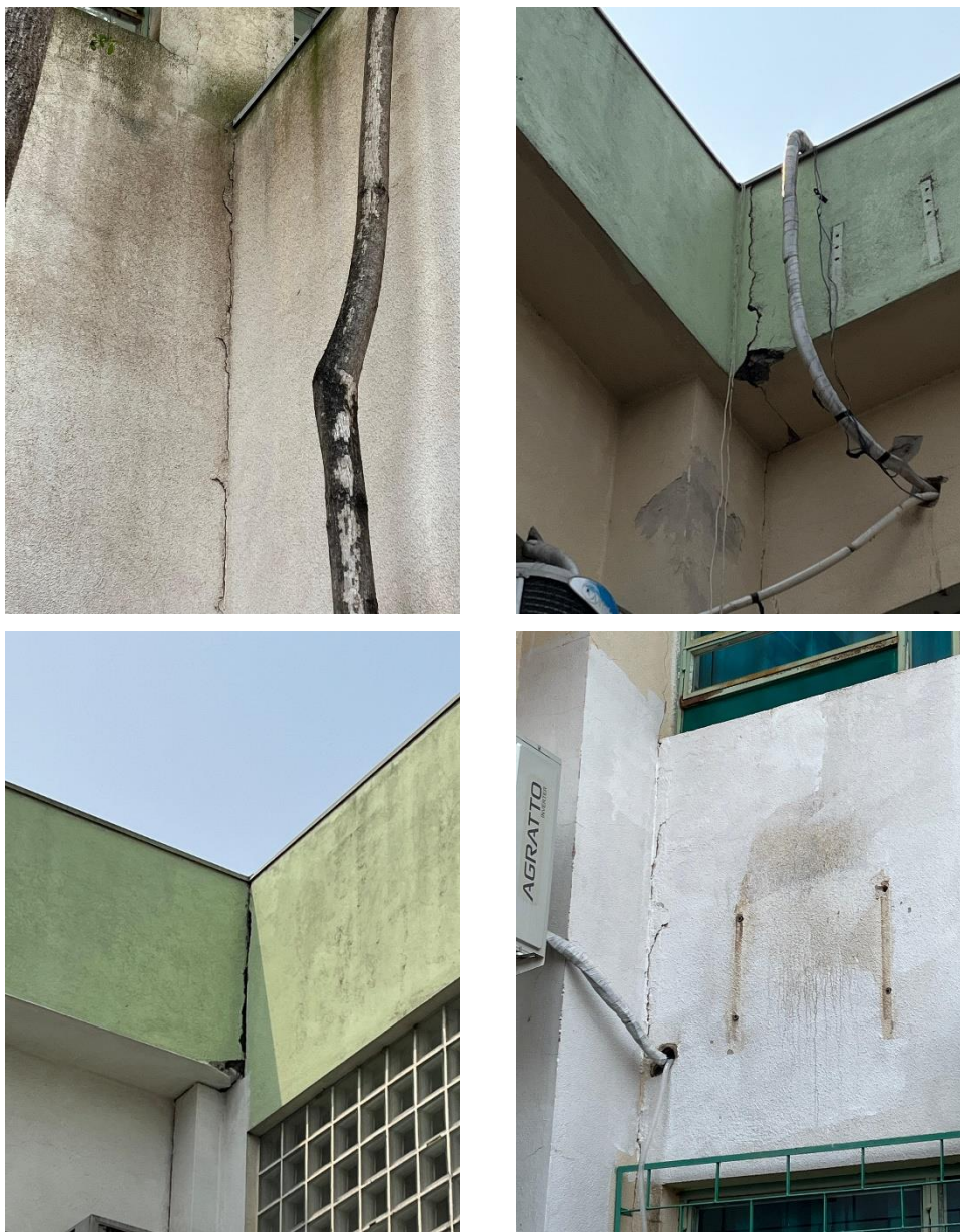
Figura 48 – Fissuras nas interfaces entre alvenaria e superestrutura
