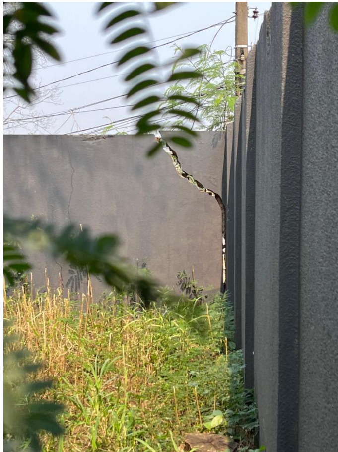
Figura 47 – Brecha no muro
