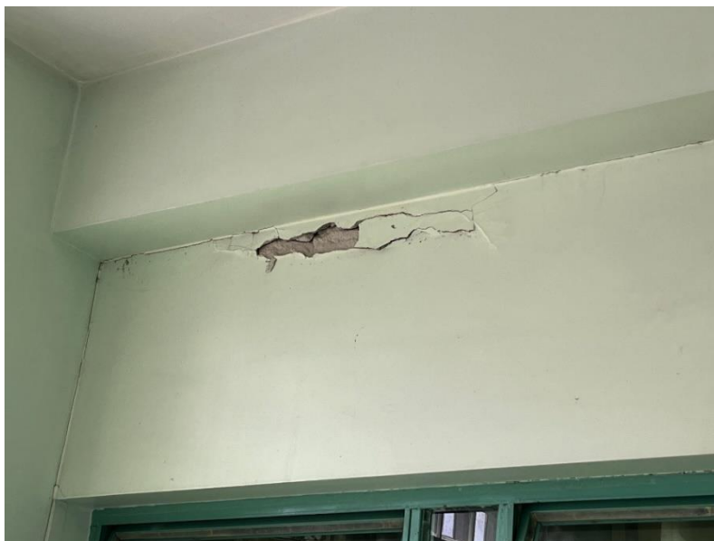
Figura 42 – Detalhe fissuras e desagregação do reboco
