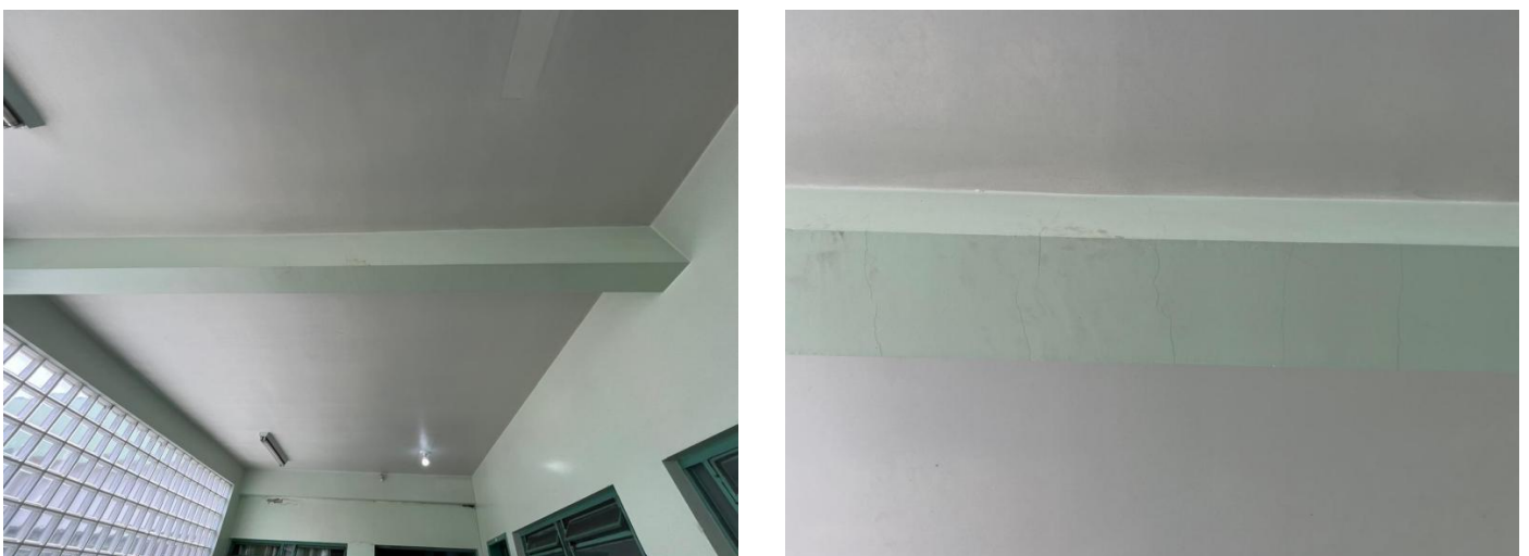
Figura 24 – Fissuras nas vigas do pavimento superior
