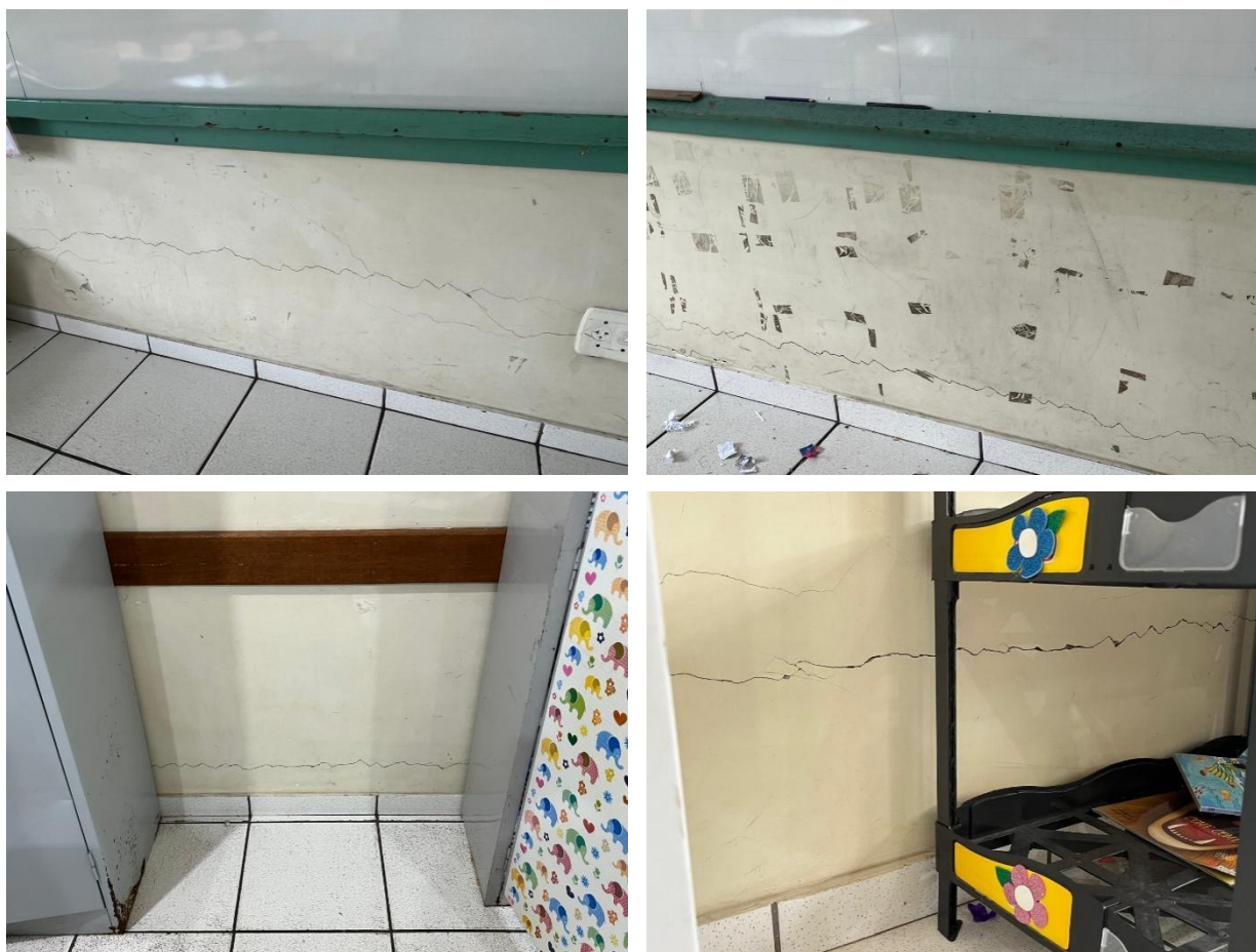
Figura 25 – Fissura na base das paredes do pavimento superior
