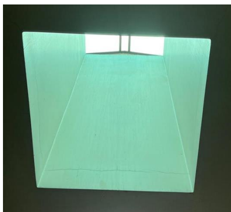
Figura 19 – Fissuras nos domus para telhado
