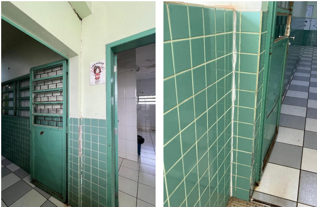
Figura 44 – Fissuras e descolamento da cerâmica
