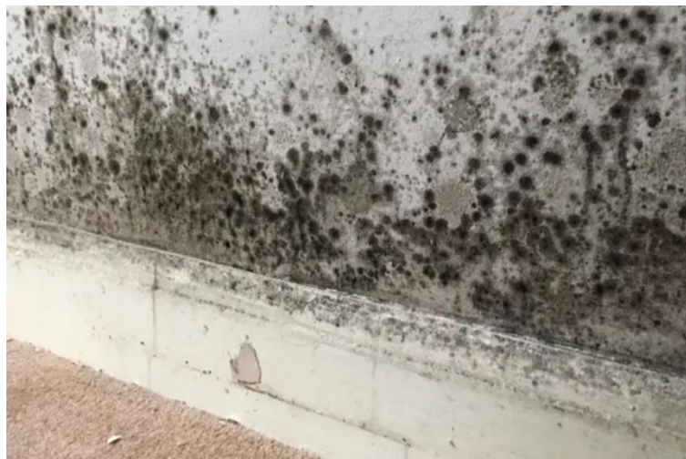
Figura 1 – Bolor em parede
