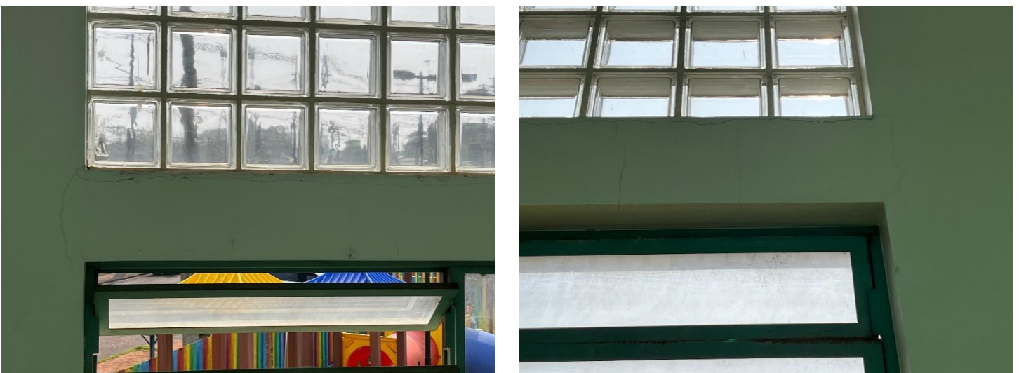
Figura 38 – Fissuras nas vigas da área da rampa
