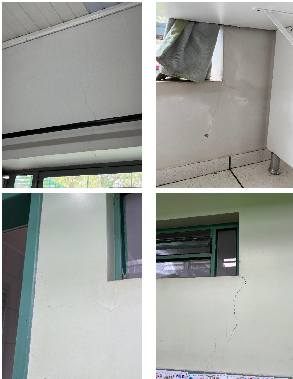
Figura 26 – Fissuras nas aberturas do pavimento térreo
