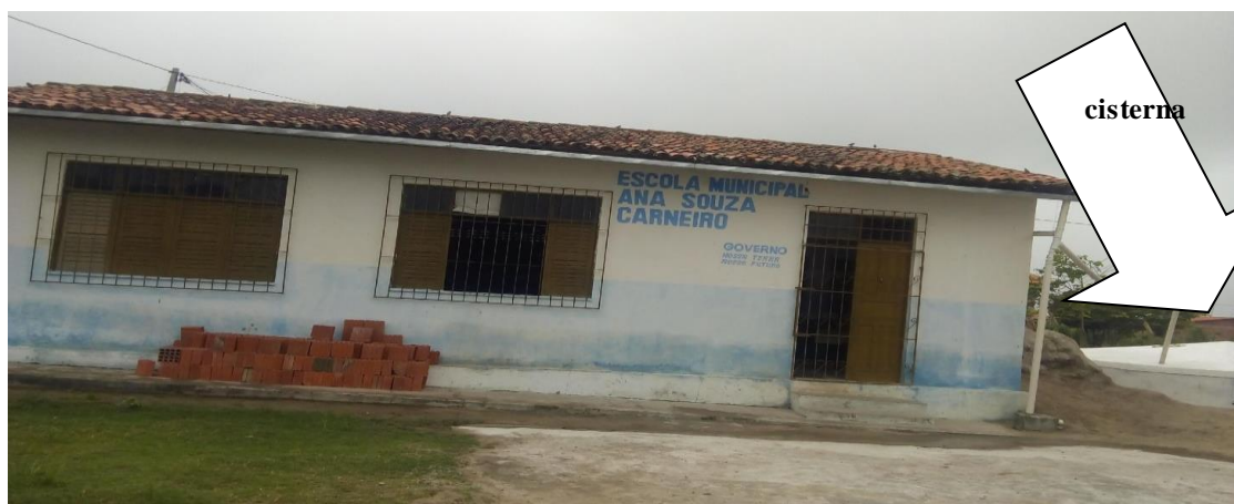
Foto 4 Arquivo pessoal: Cisterna da Escola
