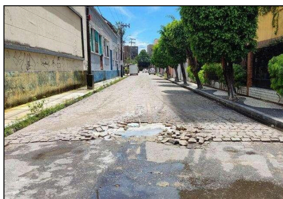
Figura 9 – Problemas de pavimentação no Praia de Iracema
