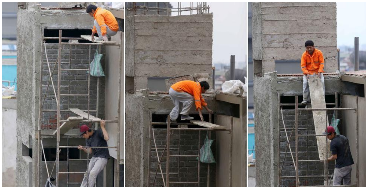
Figura 3: Obreros sin protección arriesgan sus vidas. Fuente: El comercio. Acceso: 2021
