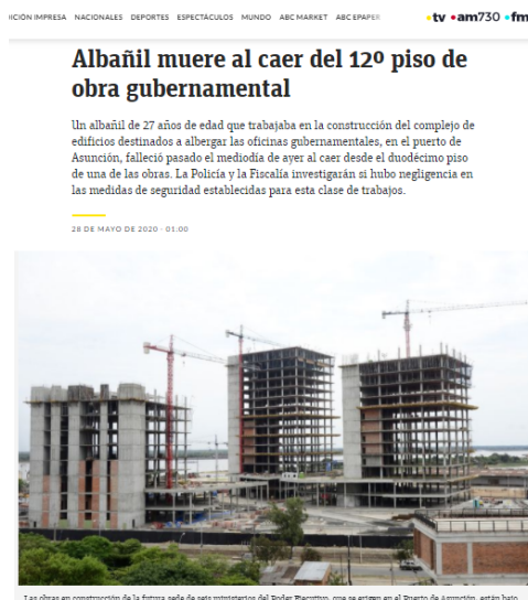
Figura 37: Accidente en la construcción civil en Py
