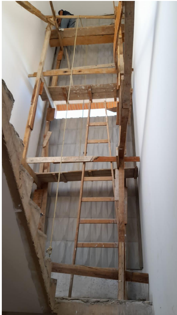
Figura 41: Albañil trabajando sin equipamiento de seguridad
