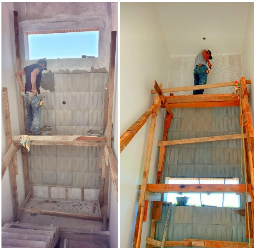
Figura 39, 40: Albañil trabajando sin equipamiento de seguridad. Fuente: Foto de la autora, 2022.
