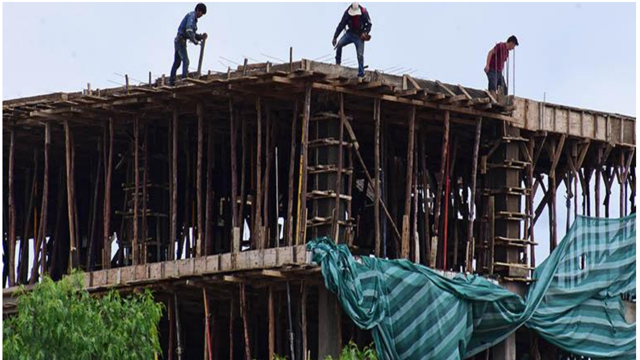
Figura 2: Obreros trabajan al límite y sin protección en edificios. Fuente: Los tiempos. Acceso: 2021
