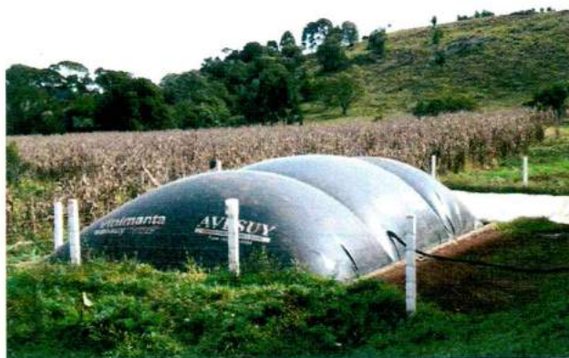
Figura 4 - Biodigestor Lagoa Coberta em propriedade em Concórdia, SC. (OLIVEIRA & HIGARASHI, 2006)
