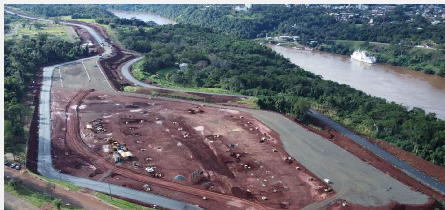
Imagem 66 - Obra da perimetral leste em Foz do Iguaçu. Fonte: Agência Estadual de Notícias, DÉR.
