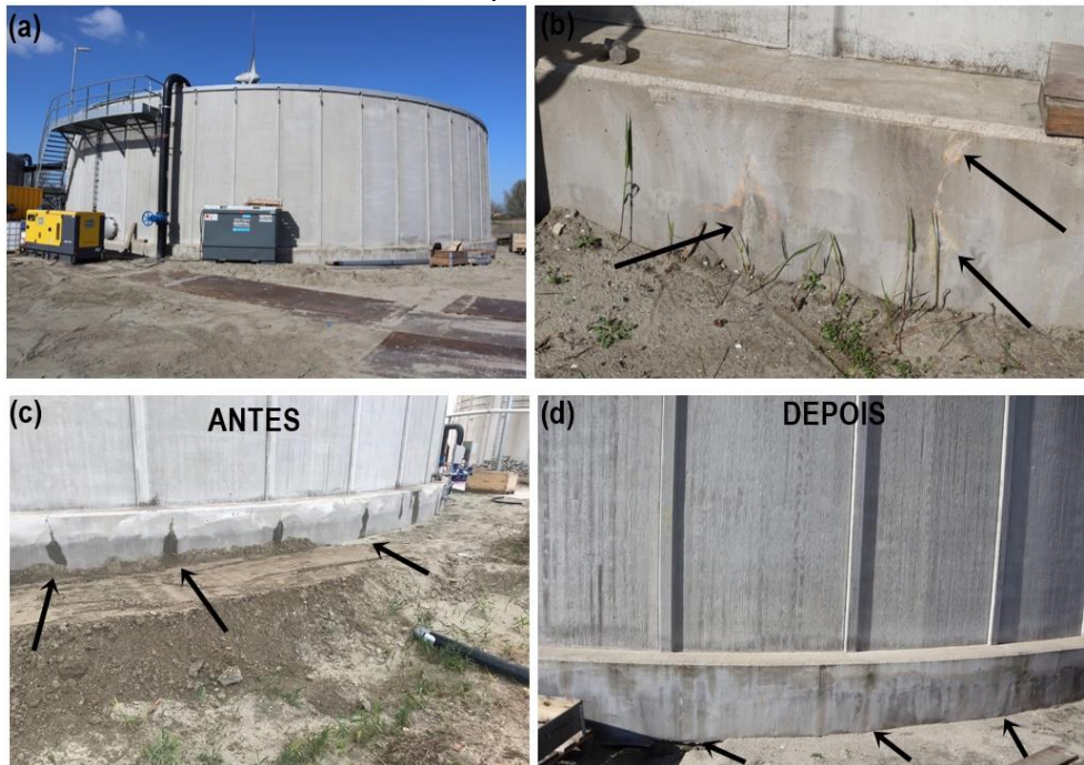
Figura 7 – Tanque de expansão com aditivo à base de bactérias (a) Imagem do tanque (b) fissuras seladas por precipitação de \text{CaCO}_3 (c) fissuras com entrada de umidade (d) fissuras autocicatrizadas após a entrada de umidade.
