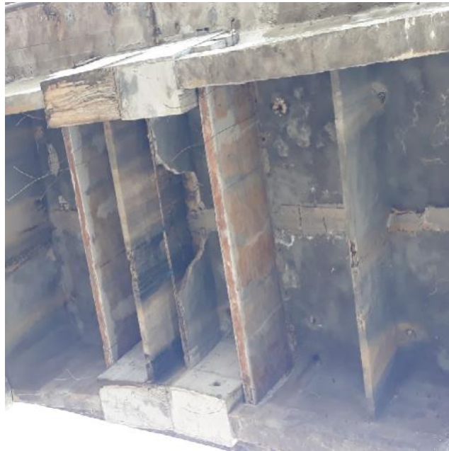
Figura 98 - Transversina - Concreto desagregado com armadura exposta e oxidada, rompimento da transversina
