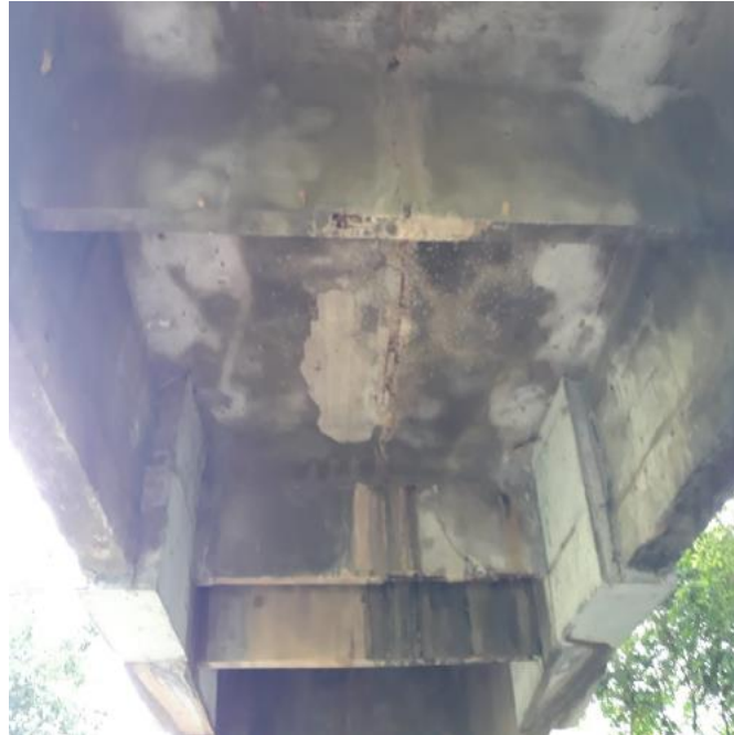
Figura 78 - Laje - concreto desagregado com armadura exposta e oxidada
