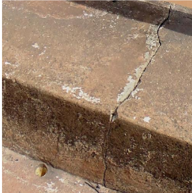
Figura 82 - Guarda-rodas - fissura profunda aberta
