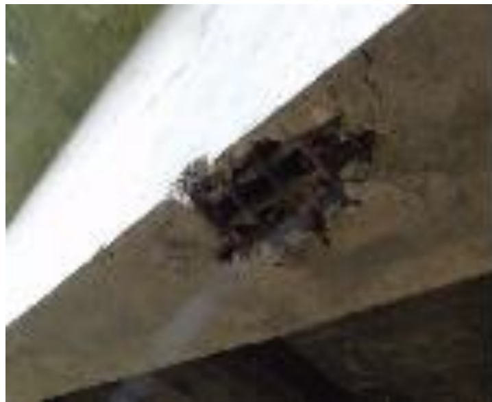
Figura 28 - Viga T ou I-Concreto desagregado com armadura exposta e oxidada
