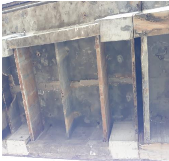
Figura 99 - Transversina - Concreto desagregado com armadura exposta e oxidada
