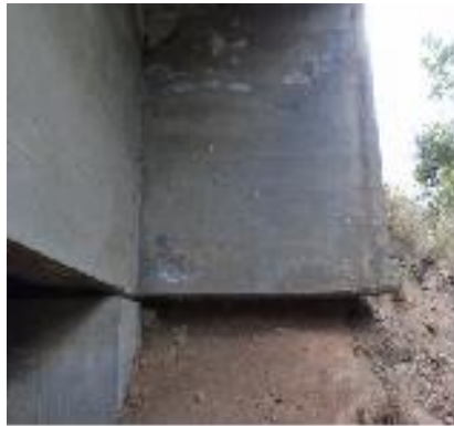
Figura 40 - Ala com Infiltração e mancha de umidade, lixiviação e mancha de carbonatação
