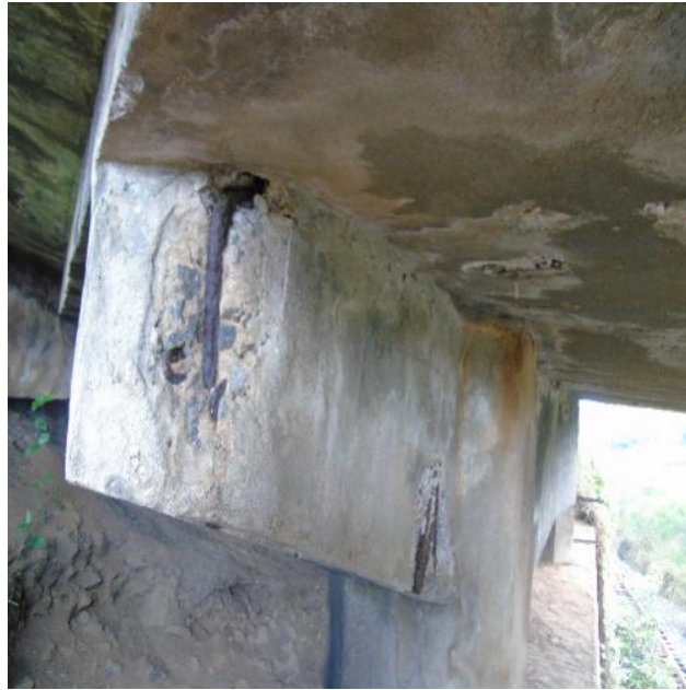
Figura 112 - Viga de contraventamento-Concreto desagregado com armadura exposta e oxidada
