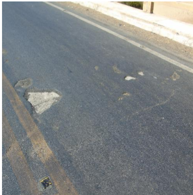
Figura 67 - Pavimento asfáltico - buraco na pista
