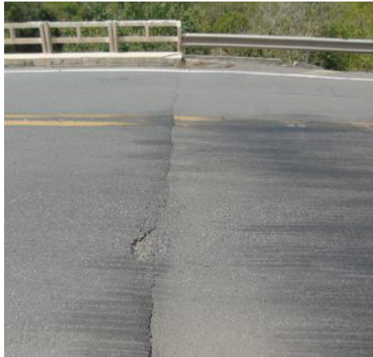
Figura 24 - Junta de dilatação - Junta danificada, inexistente ou expelida
