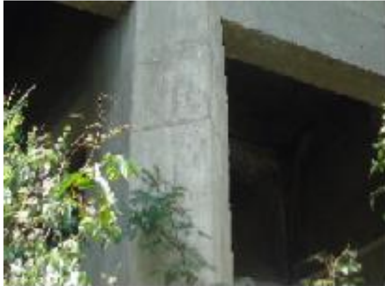
Figura 25 - Pilar com manchas de umidade
