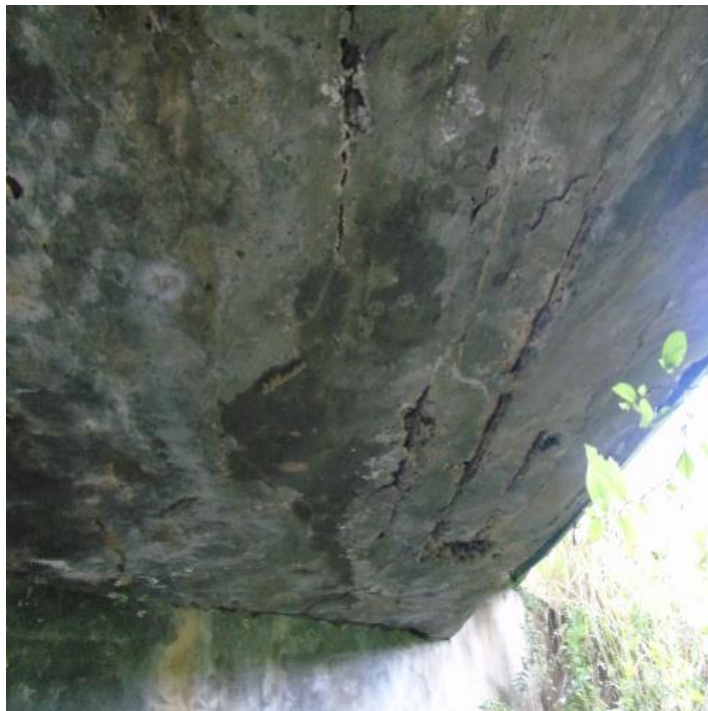
Figura 119 - Ponte em laje-Concreto desagregado com armadura exposta e oxidada
