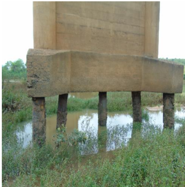
Figura 95 - Bloco - Concreto desagregado com armadura exposta e oxidada / Estaca - estaca desconfiada
