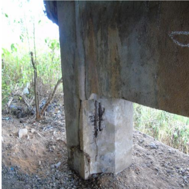
Figura 118 - Pilar-Concreto desagregado com armadura exposta e oxidada
