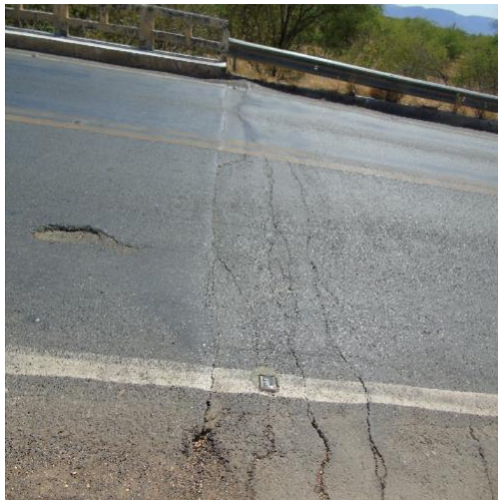
Figura 71 - Junta de dilatação - junta de dilatação danificada, inexistente ou expelida
