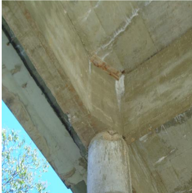
Figura 66 - Pilar em colunas-deslocamento de concreto com armadura exposta
