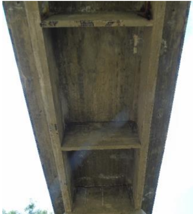
Figura 33 - Transversina com concreto desagregado com armadura exposta e oxidada, ferragem principal exposta
