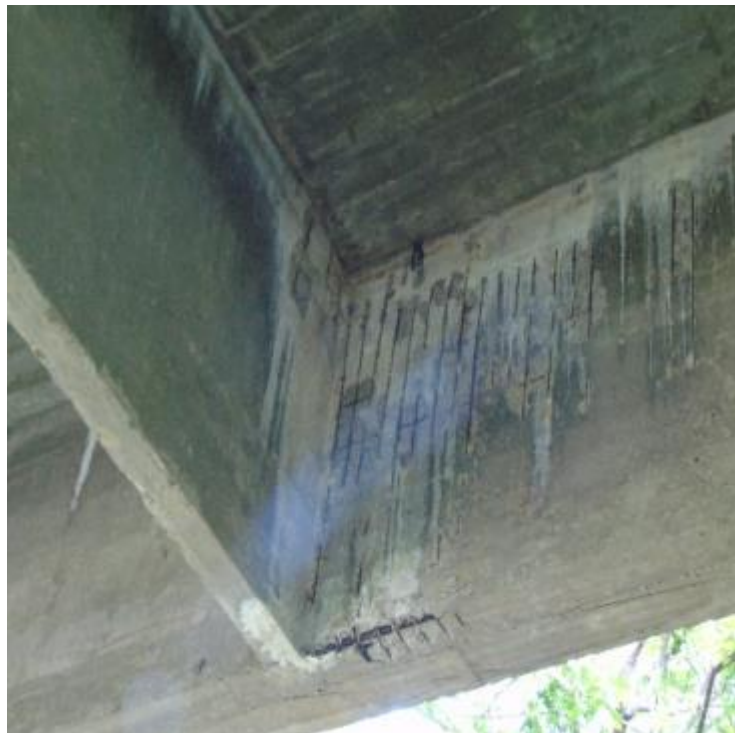
Figura 30 - Viga com concreto desagregado com armadura exposta e oxidada, degradação devido à ação biológica
