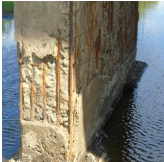
Figura 4 - Corrosão das armaduras
