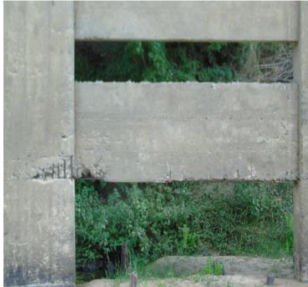
Figura 42 - Pilar/Viga de contraventamento - Concreto desagregado com armadura exposta; Pilar-mancha de umidade
