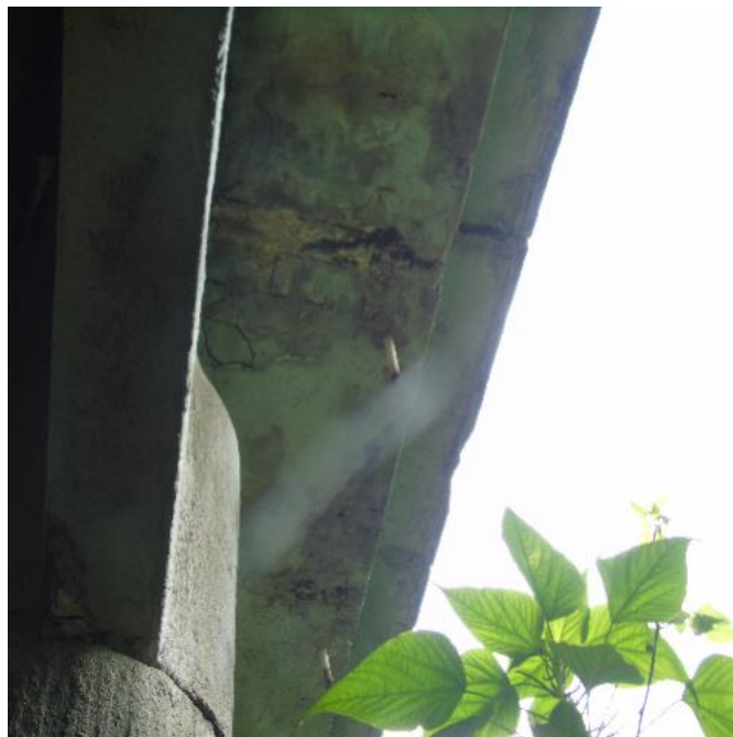
Figura 79 - Laje - Concreto desagregado com armadura exposta e oxidada.
