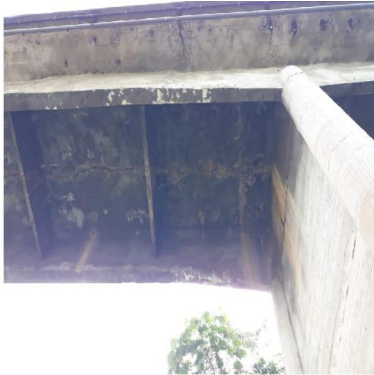
Figura 88 - Laje - Concreto desagregado com armadura exposta e oxidada / Viga – lixiviação
