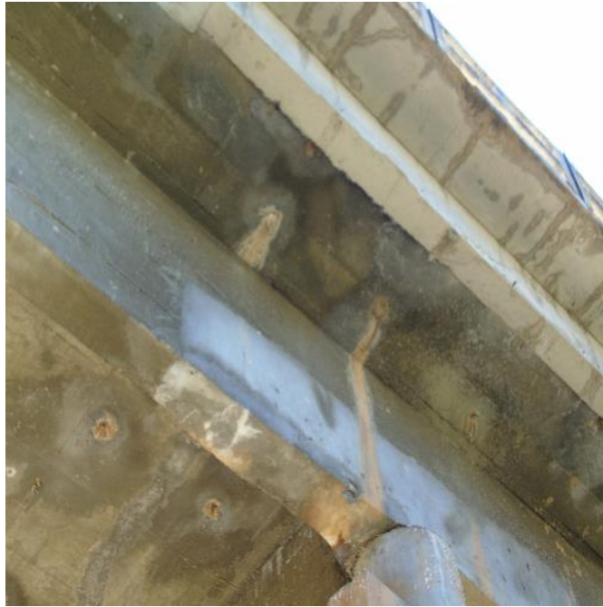
Figura 64 - Viga T ou I-Concreto desagregado com armadura exposta e oxidada, fissura superficial
