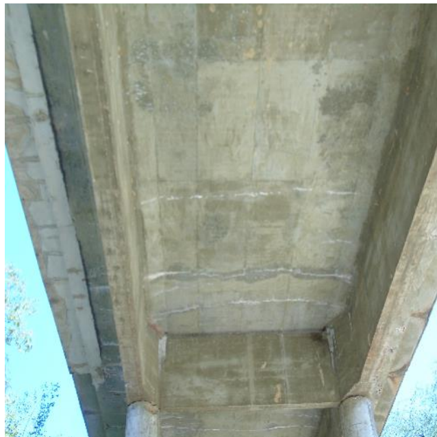
Figura 65 - Laje de C.A-Fissura Profunda Fina, lixiviação e carbonatação
