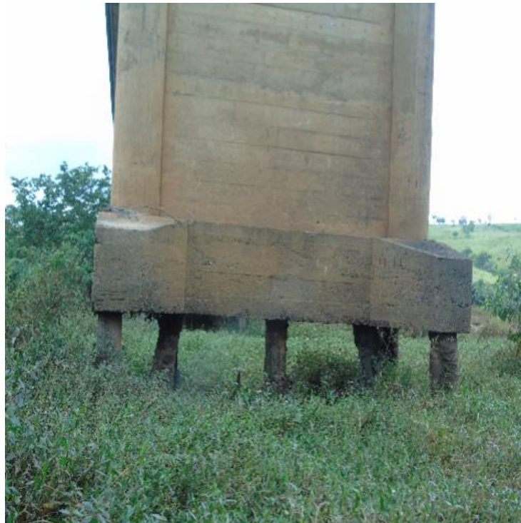
Figura 89 - Estaca - Estaca desconfinada
