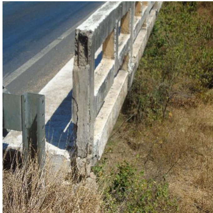
Figura 75 - Guarda-Corpo - Deslocamento de concreto com armadura exposta
