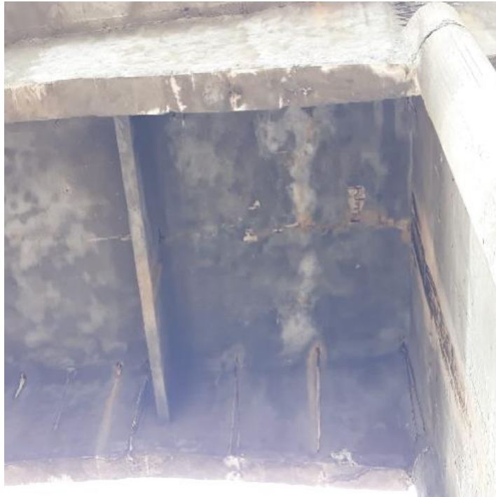
Figura 100 - Viga, laje - fissura profunda fina, lixiviação e mancha de carbonatação
