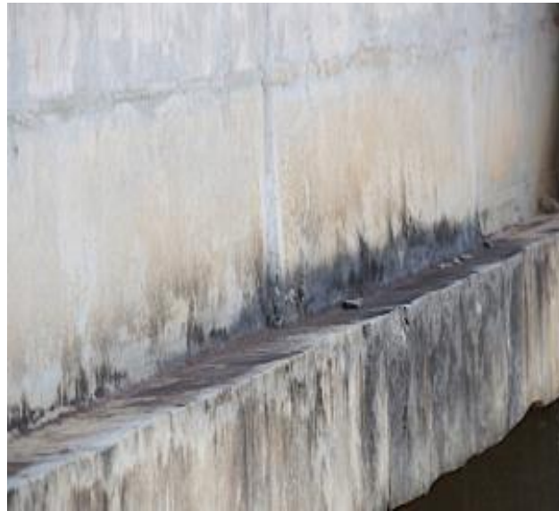
Figura 8 - Manchas de umidade
