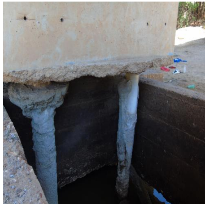
Figura 61 - Estaca de C.A-Concreto desagregado com armadura exposta e oxidada, estaca desconfinada
