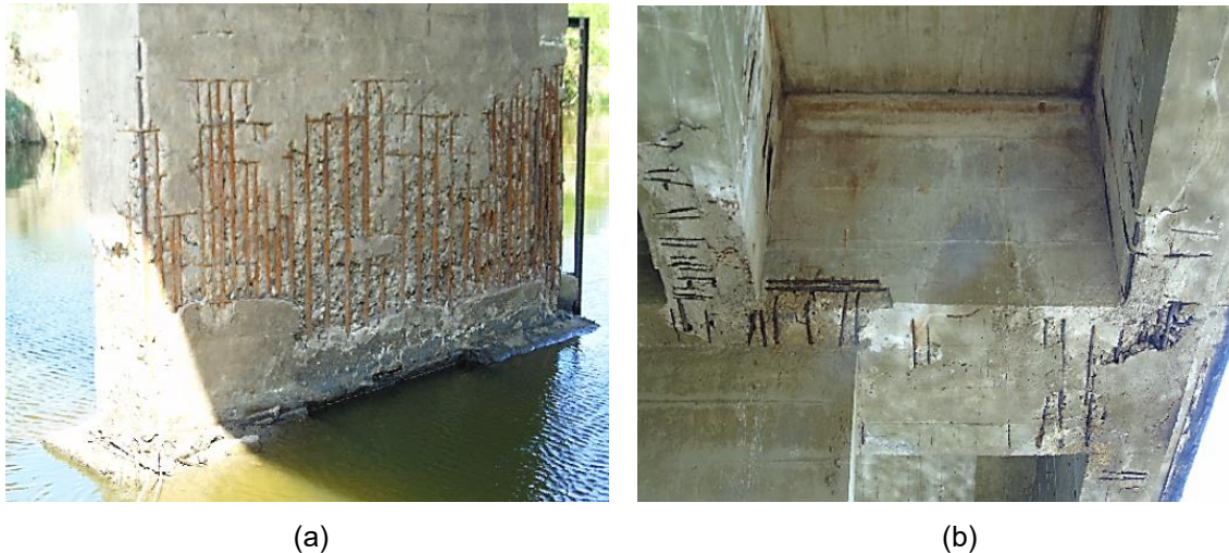
Figura 13 - Principais problemáticas. (a) Pilar com concreto desagregado com armadura principal muito oxidada; (b) Viga T e Transversina com armadura sem cobertura e oxidada
