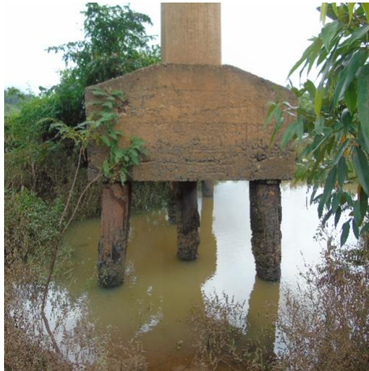
Figura 97 - Bloco - armadura sem cobertura
