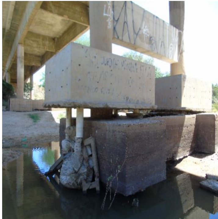
Figura 62 - Estaca de C.A-Concreto desagregado com armadura exposta e oxidada, estaca desconfinada
