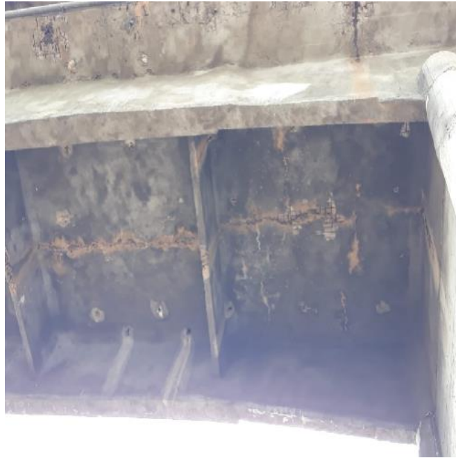
Figura 96 - Laje - Concreto desagregado com armadura exposta e oxidada
