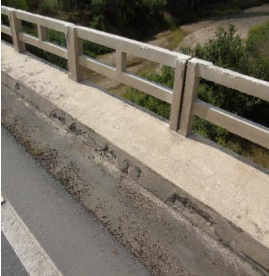
Figura 37 - Guarda corpo com deslocamento de concreto com armadura exposta e oxidada
