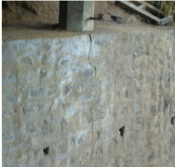
Figura 6 - Encontro com fissura profunda
