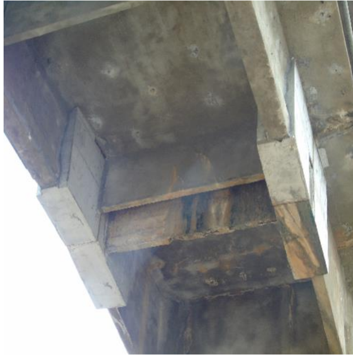
Figura 102 - Transversina - mancha de umidade, infiltração no concreto, concreto desagregado com armadura exposta
