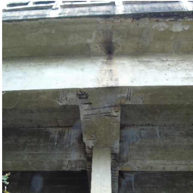
Figura 50 - Viga T, Transversina-Armadura sem cobertura/Viga T, Laje-Mancha de umidade, Lixiviação
