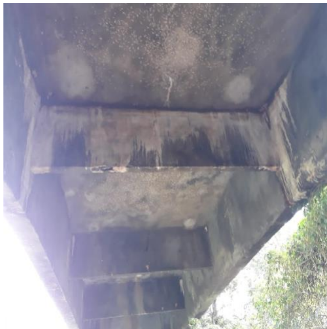
Figura 81 - Transversina - degradação biológica, concreto desagregado com armadura exposta e oxidada
