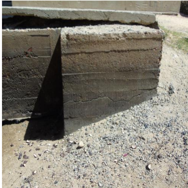
Figura 60 - Bloco de C.A-Fissura profunda aberta
