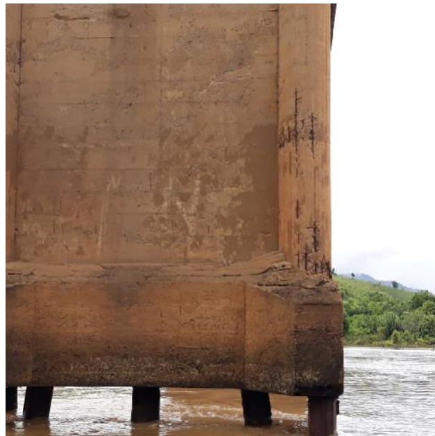
Figura 87 - Pilar - concreto desagregado / Parede de contraventamento - armadura sem cobertura
