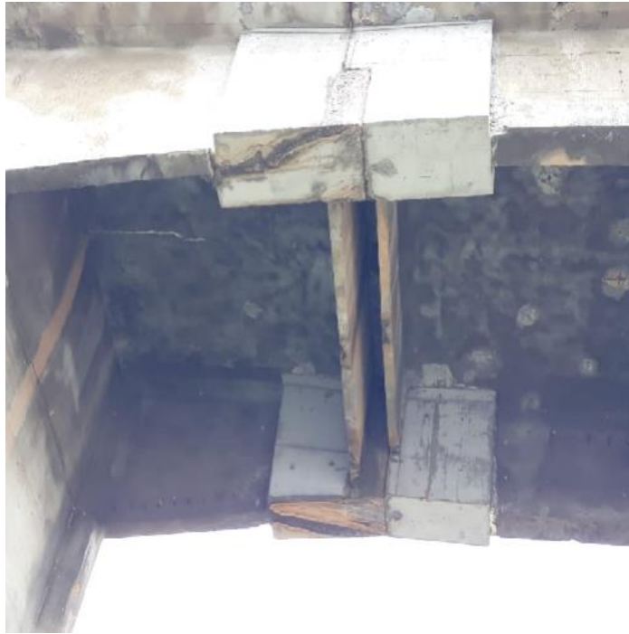
Figura 92 - Dente gerber - mancha de umidade, infiltração no concreto / Laje - fissura profunda fina, lixiviação
