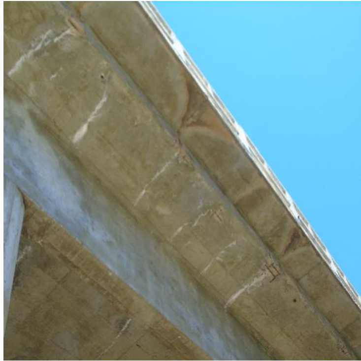
Figura 68 - Laje de C.A-Fissura Profunda Fina, lixiviação e carbonatação
