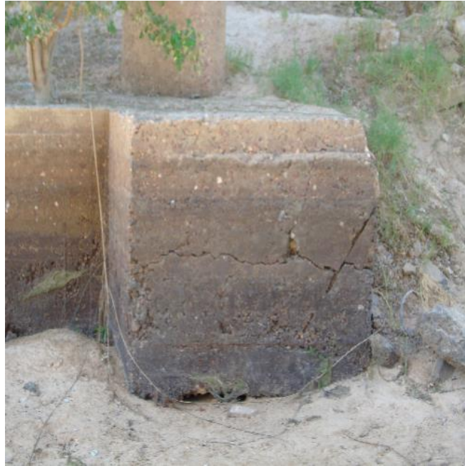
Figura 74 - Bloco de C.A-Concreto desagregado com armadura exposta e oxidada
