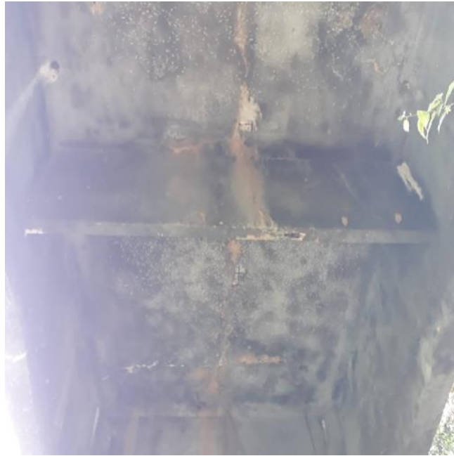
Figura 84 - Laje - concreto desagregado com armadura exposta e oxidada, mancha de umidade
