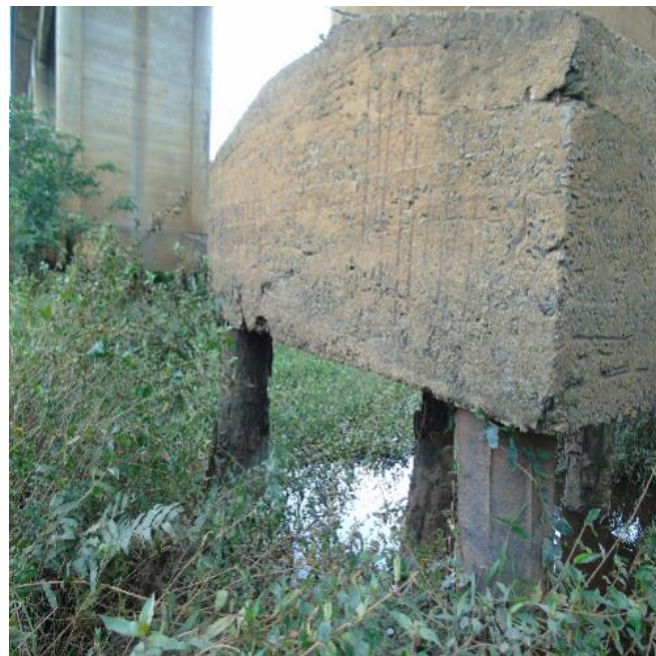
Figura 91 - Estaca - Estaca desconfinada
