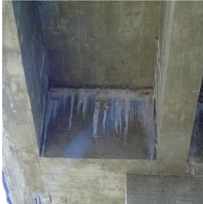
Figura 54 - Transversina- Armadura sem cobrimento
