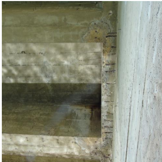
Figura 49 - Transversina-Armadura sem cobrimento
