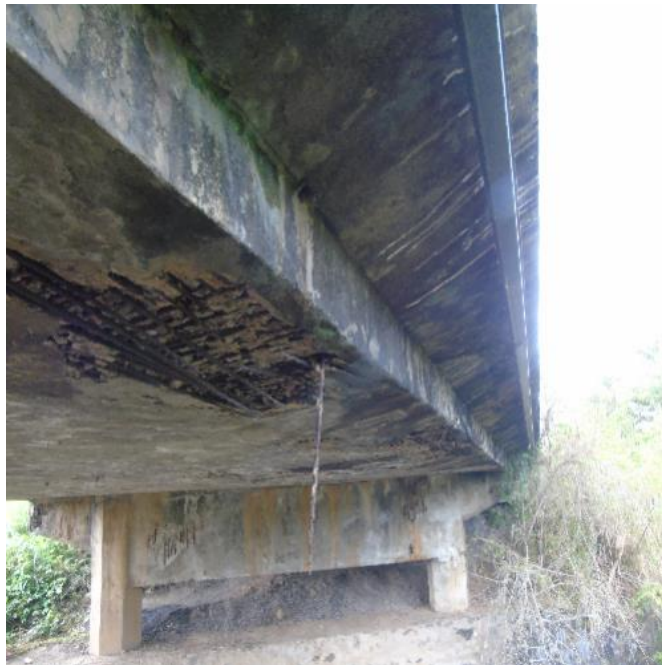
Figura 113 - Ponte em laje-Concreto desagregado, Infiltração no concreto, umidade, armaduras rompidas
