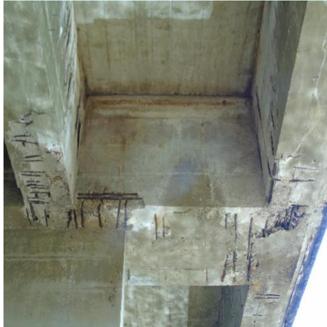
Figura 46 - Viga T, Transversina-Armadura sem cobrimento
