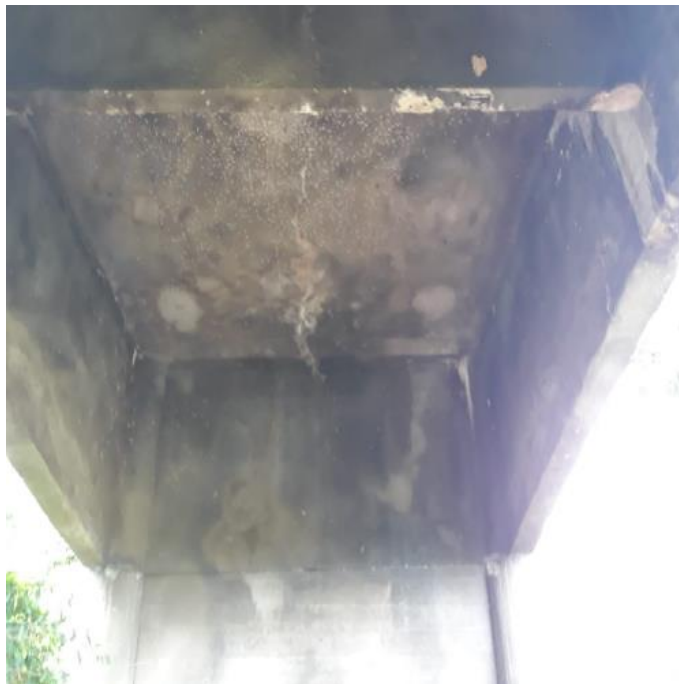
Figura 83 - Laje - fissura profunda fina, lixiviação e mancha de carbonatação
