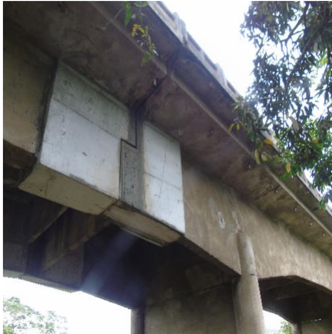
Figura 76 - Viga - Deslocamento de concreto com armadura exposta / Dente gerber - infiltração no concreto
