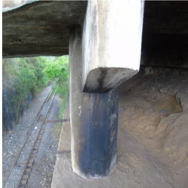
Figura 106 - Pilar- Mancha de fogo
