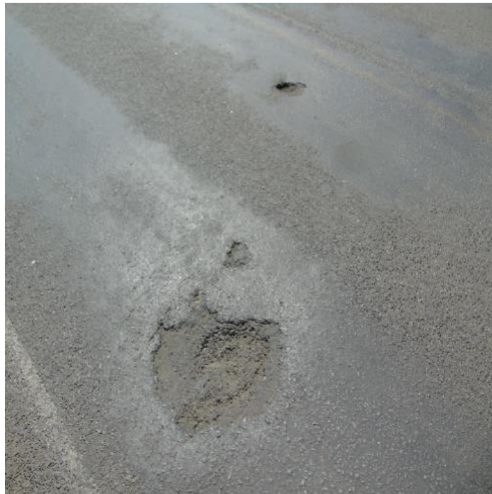
Figura 57 - Pavimento asfáltico-Danificado, Buraco na pista
