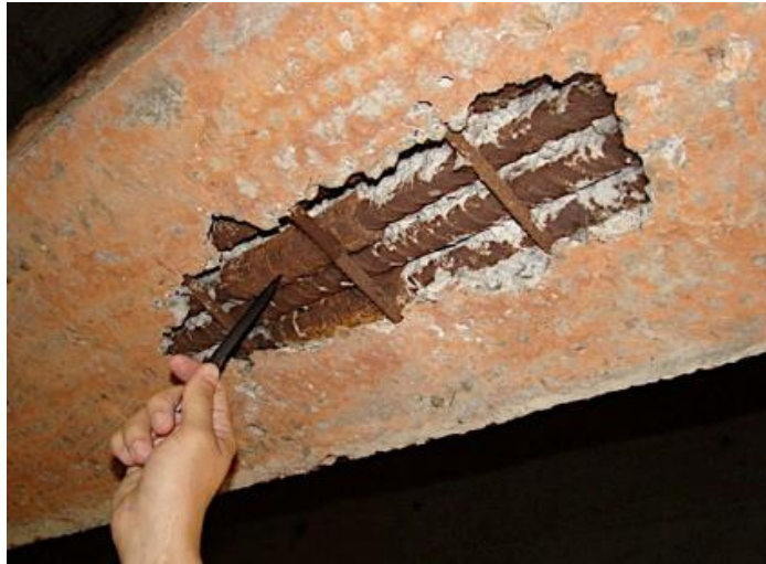
Figura 2 - Ninho de concretagem
