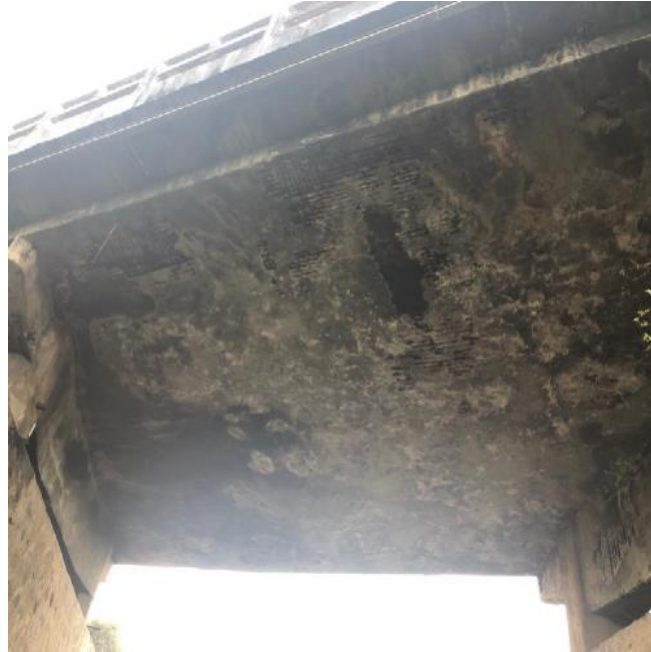
Figura 122 - Ponte em laje-Concreto desagregado com armadura exposta e oxidada, Lixiviação
