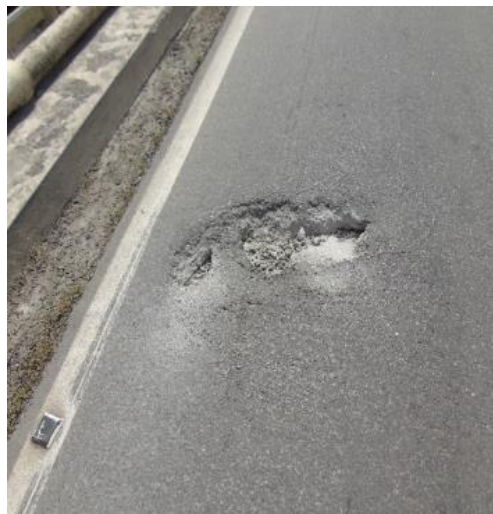
Figura 41 - Pavimento asfáltico - danificado
