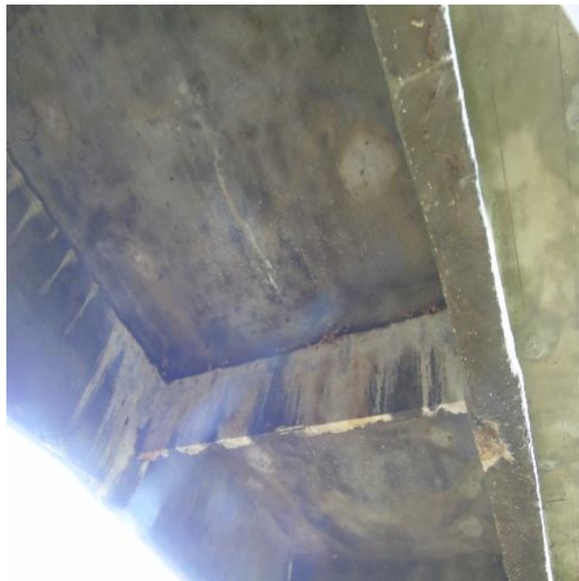
Figura 77 - Viga, transversina - degradação biológica
