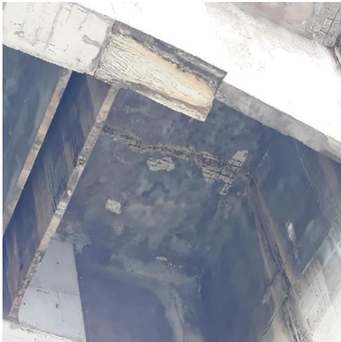
Figura 93 - Laje - Concreto desagregado com armadura exposta e oxidada
