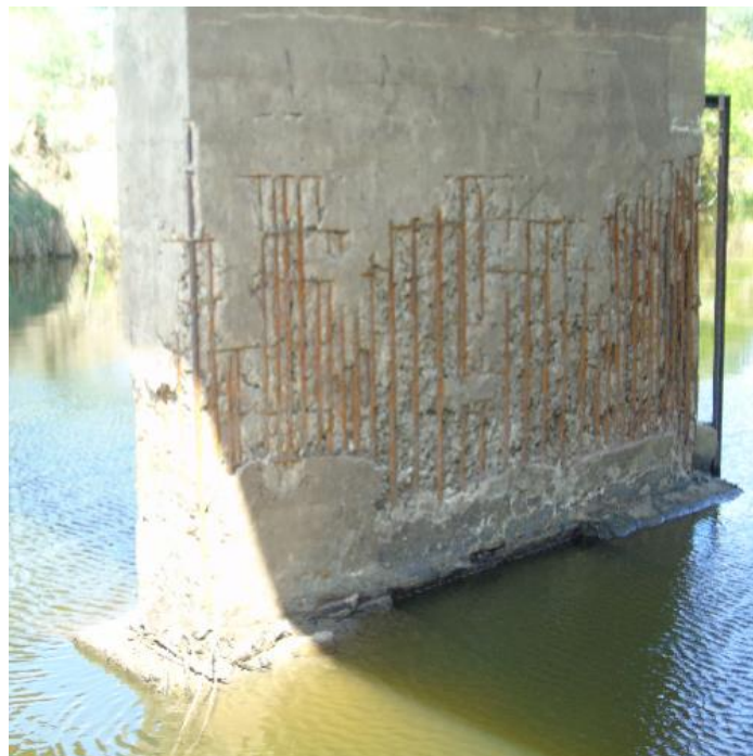
Figura 51 - Pilar-Ferragem principal muito oxidada em pontos localizados
