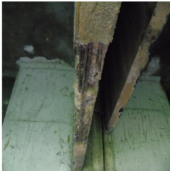
Figura 103 - Transversina - Concreto desagregado com armadura exposta e oxidada, armadura rompida
