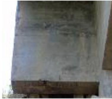
Figura 39 - Ala com concreto desagregado com armadura exposta e oxidada, infiltração e mancha de umidade
