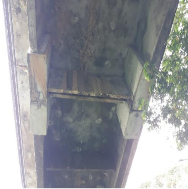
Figura 86 - Viga - Deslocamento de concreto com armadura exposta
