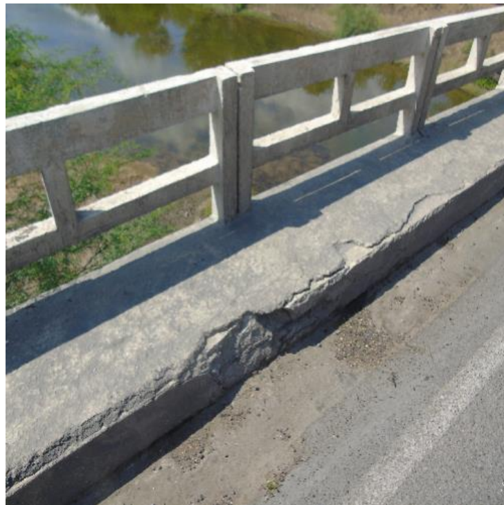
Figura 55 - Guarda rodas-Deslocamento de concreto com armadura exposta
