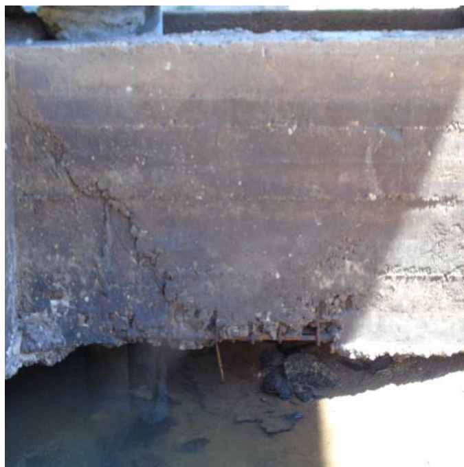
Figura 59 - Bloco de C.A-concreto desagregado com armadura exposta e oxidada
