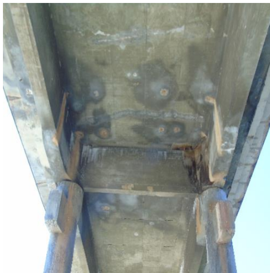
Figura 63 - Pilar em colunas-Infiltração e mancha de umidade
