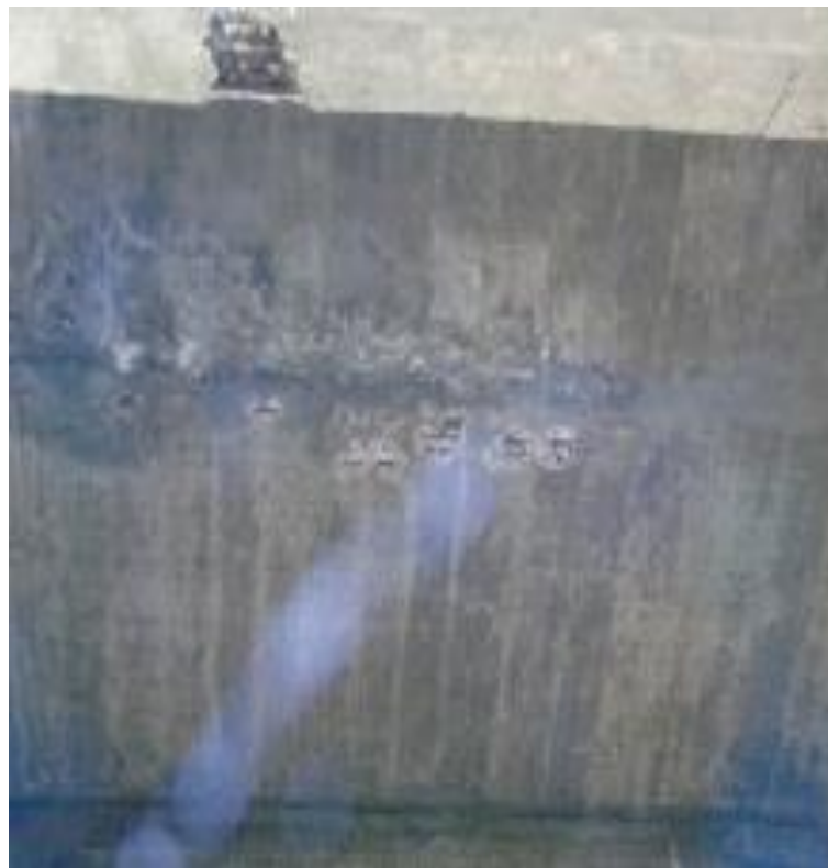
Figura 36 - Fissura profunda fina (A favor da segurança), lixiviação e carbonatação
