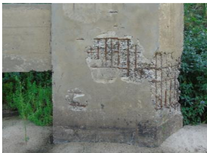
Figura 1 - Desagregação do concreto
