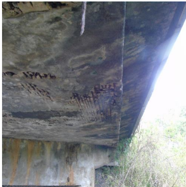
Figura 111 - Ponte em laje-Concreto desagregado com armadura exposta e oxidada, Lixiviação
