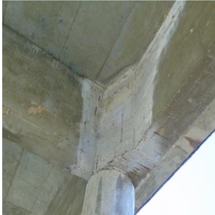
Figura 70 - Viga T ou I-Degradação devido à ação biológica, armadura sem cobrimento
