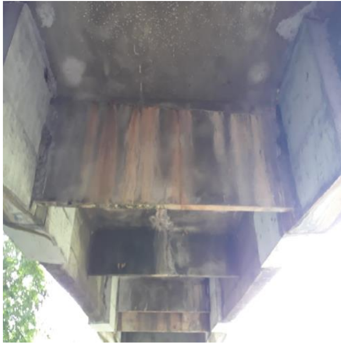
Figura 80 - Transversina - mancha de umidade
