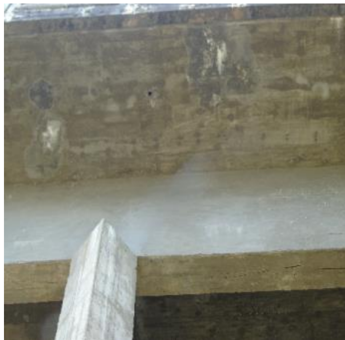
Figura 34 - Laje Infiltração e mancha de umidade, Fissura profunda fina
