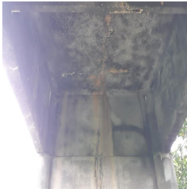
Figura 85 - Laje - fissura profunda fina, mancha de umidade, lixiviação e mancha de carbonatação
