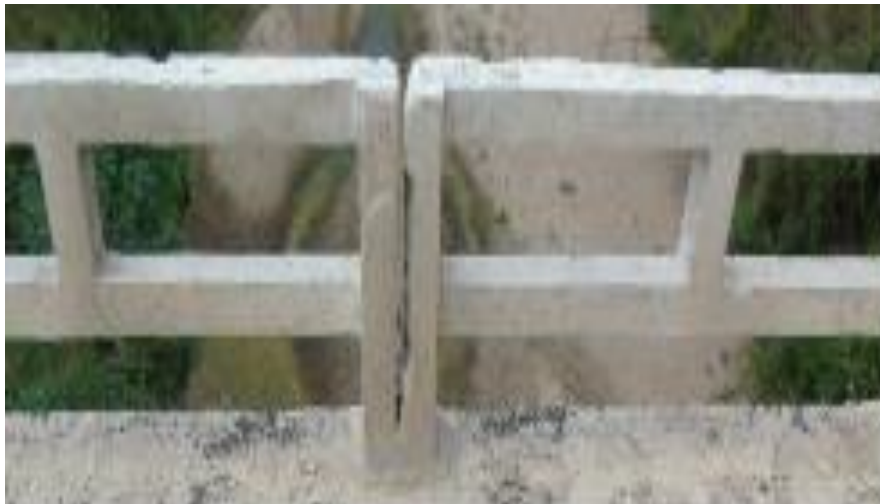
Figura 38 - Guarda corpo com deslocamento de concreto com armadura exposta e oxidada
