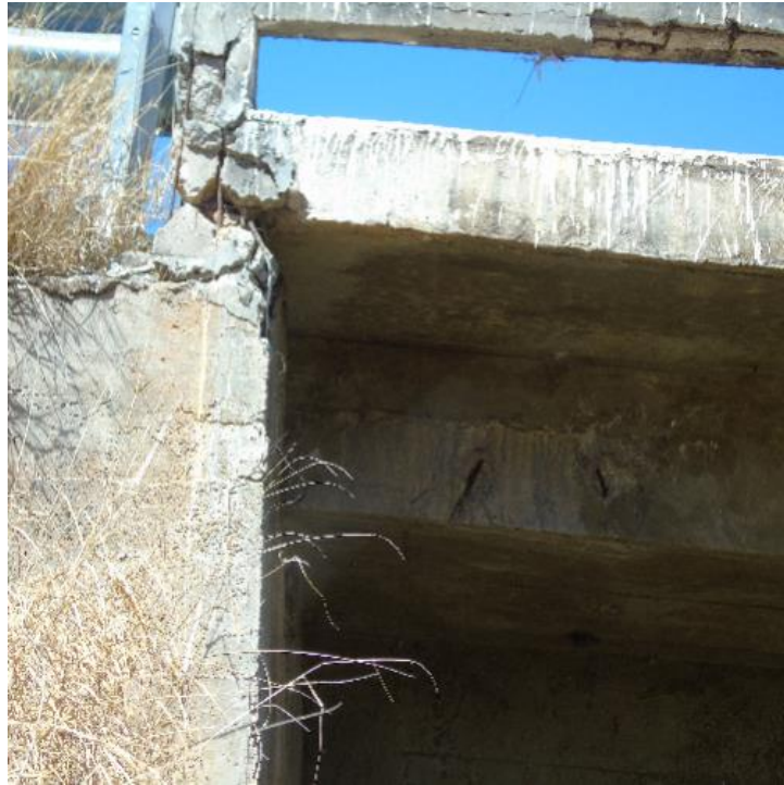
Figura 72 - Laje de C.A-Concreto desagregado com armadura exposta e oxidada
