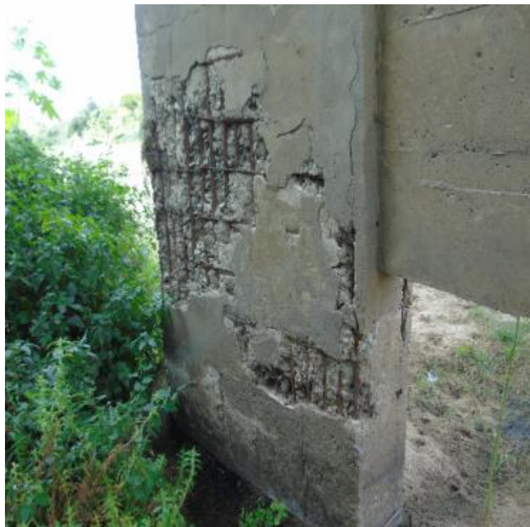
Figura 26 - Pilar com ferragem principal muito oxidada em pontos localizados, concreto desagregado
