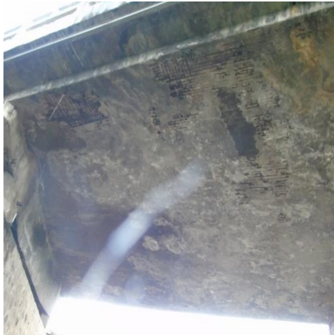
Figura 115 - Ponte em laje-Concreto desagregado com armadura exposta e oxidada, Lixiviação
