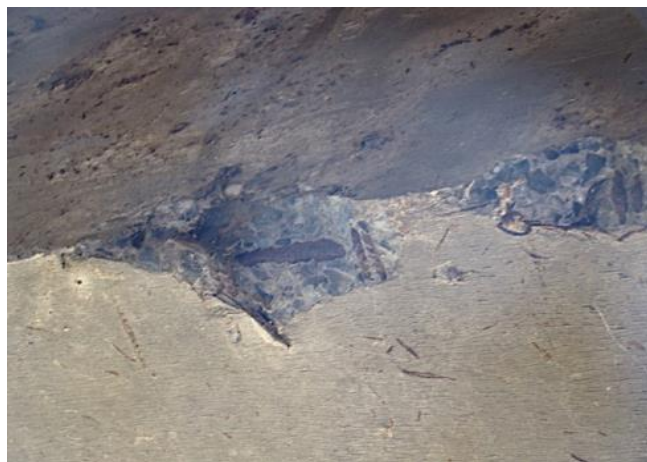
Figura 7 - Deslocamento do concreto
