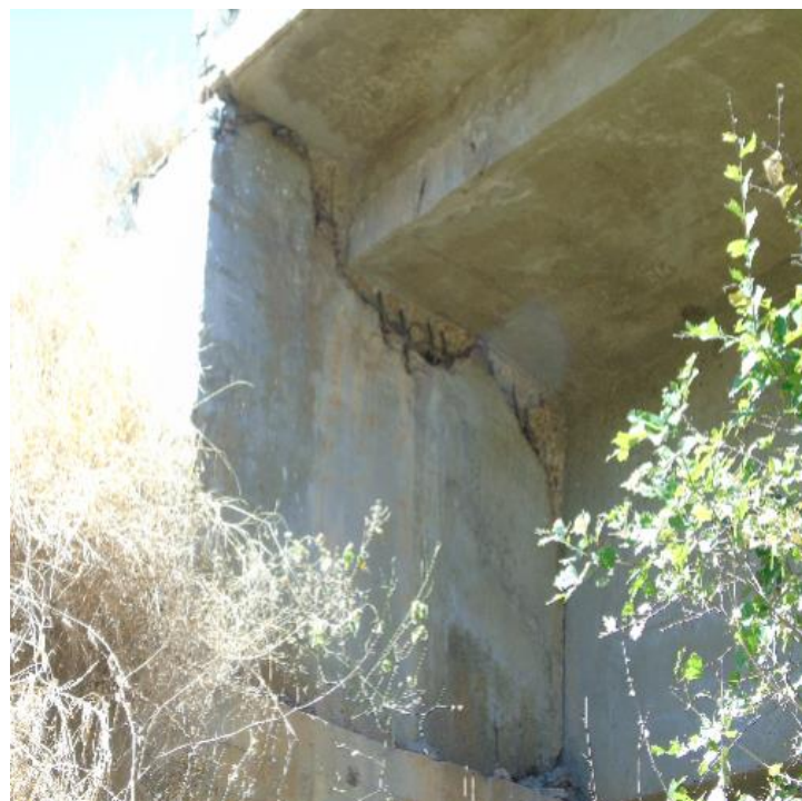
Figura 73 - Cortina de C.A-Concreto desagregado com armadura exposta e oxidada, lixiviação e carbonatação
