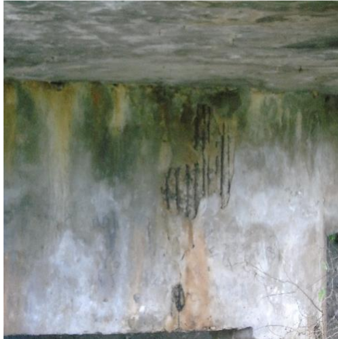
Figura 114 - Viga de contraventamento-Concreto desagregado, umidade, lixiviação, fissura profunda aberta ( w > 0,3 mm)
