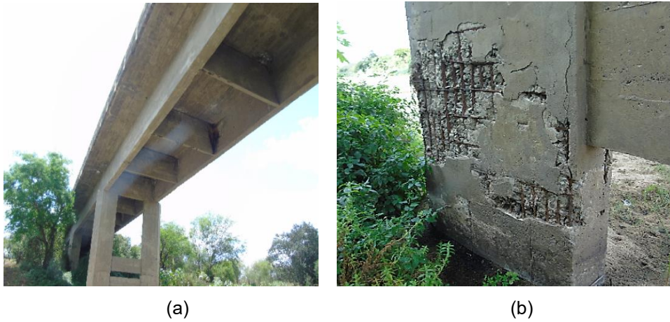
Figura 11 - Ponte sobre o Rio do Peixe. (a) Vista inferior; (b) Pilar com concreto desagregado e armadura exposta e oxidada
