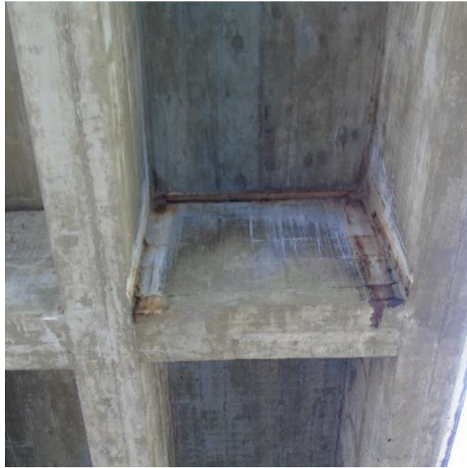
Figura 44 - Transversina, Viga T-Degradação devido ação biológica
