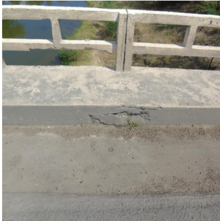
Figura 56 - Guarda rodas-Deslocamento de concreto com armadura exposta
