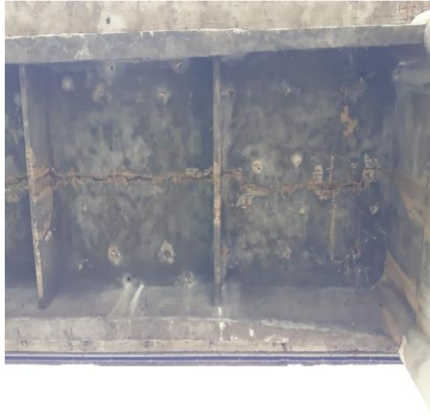
Figura 94 - Laje - Concreto desagregado com armadura exposta e oxidada
