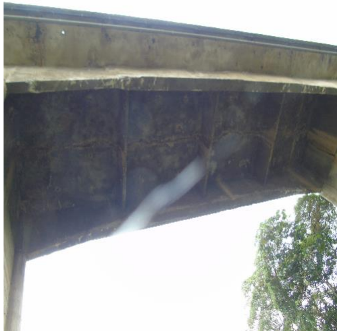
Figura 90 - Laje - Concreto desagregado com armadura exposta e oxidada / Viga – lixiviação
