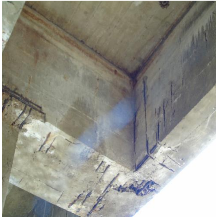
Figura 48 - Viga T, Transversina-Armadura sem cobrimento/Viga T-Concreto desagregado com armadura exposta
