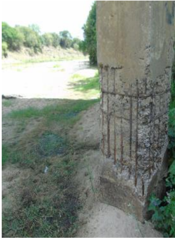
Figura 27 - Pilar com ferragem principal muito oxidada em pontos localizados, concreto desagregado
