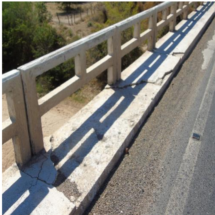
Figura 69 - Guarda-rodas - Deslocamento de concreto com armadura exposta
