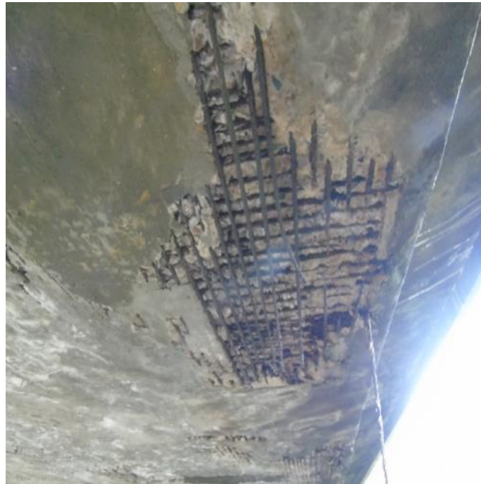
Figura 110 - Ponte em laje-Concreto desagregado com armadura exposta e oxidada; Armaduras rompidas
