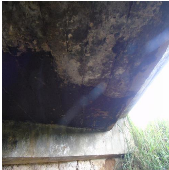
Figura 107 - Ponte em laje-Mancha de fogo, Lixiviação e mancha de carbonatação
