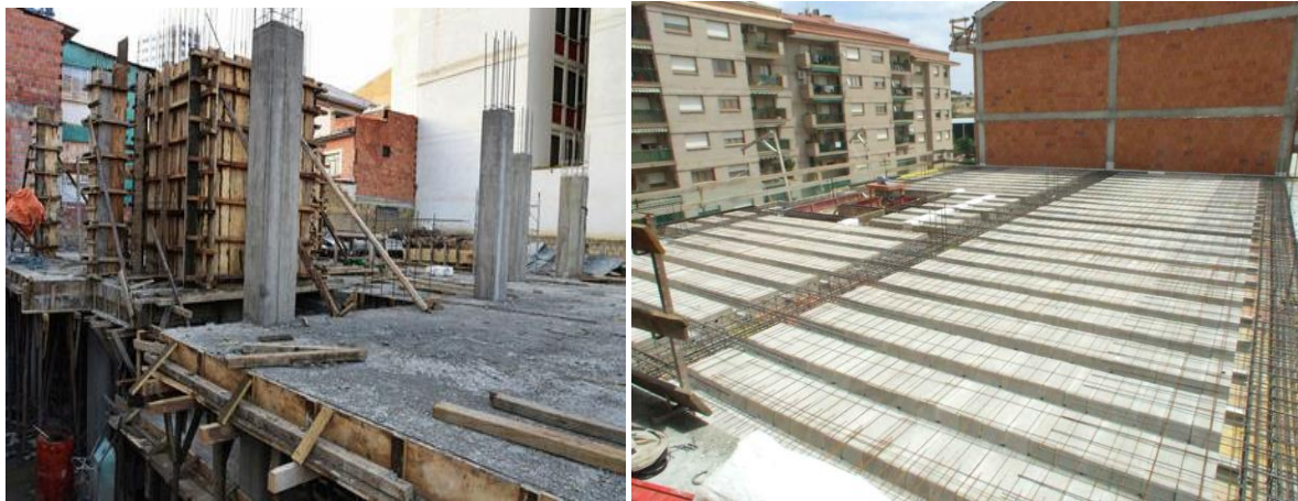
Figura 19 – Estructuras usadas en la zona de Bajo Llojeta Fuente - Foto del Autor (2019)
