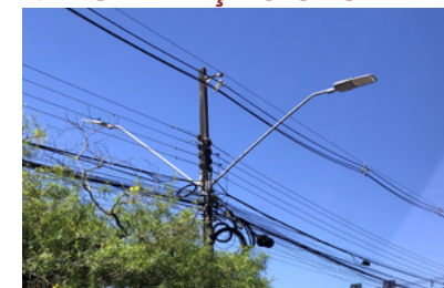
Figura 78 – Iluminação Av. S. A. Sasdelli. Fonte: Google maps, 2022.
