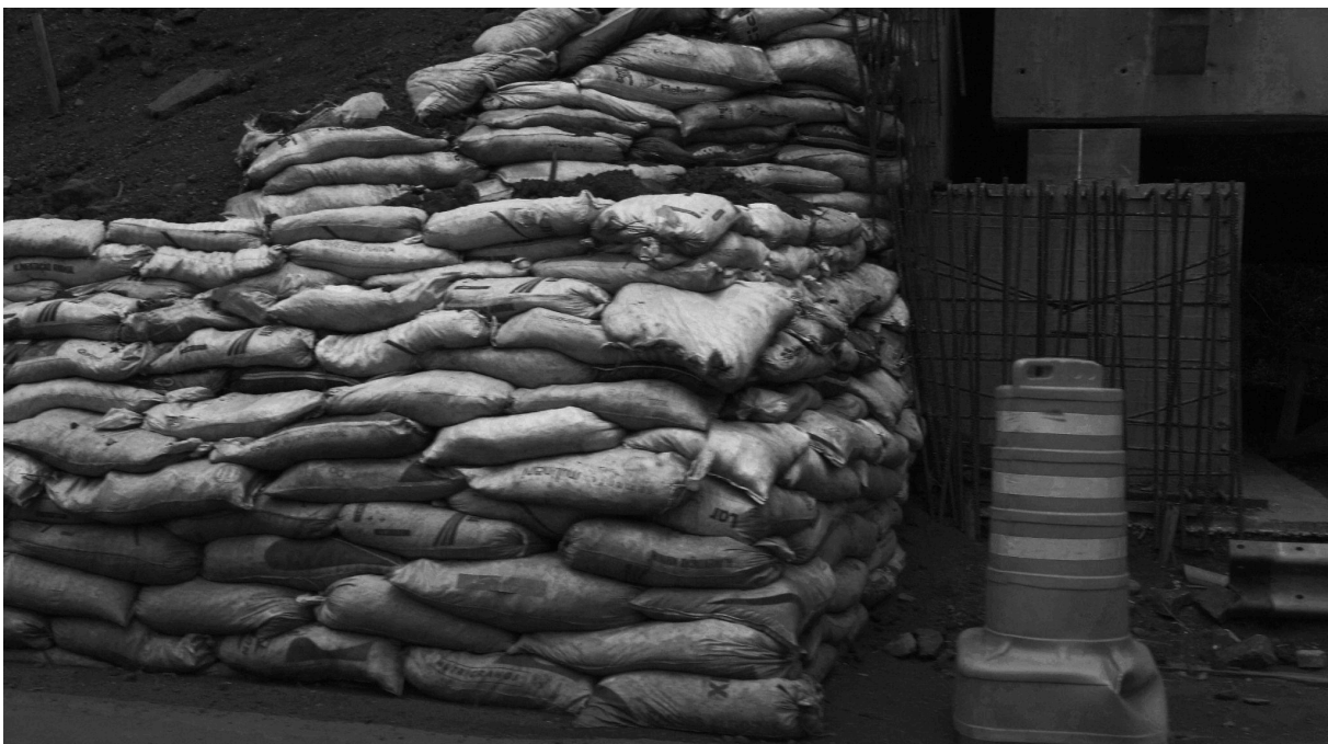
Figura 91: Frames de vídeos obra da quadruplicação da Avenida Cataratas, Frame: Manuel Corman, 2023.
