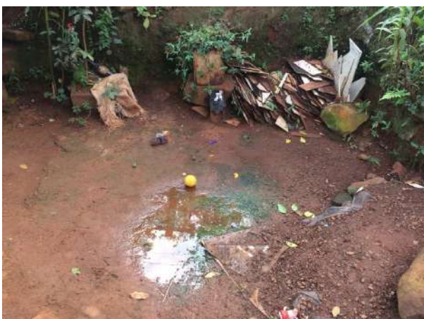
Imagem 33: Fossa séptica por fora, com bastante umidade.
