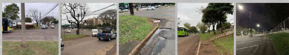
Figura 78: Situações encontradas no trecho: ausência de indicação de parada no canteiro central, ausência de faixa de travessia nas vias laterais, falhas na pavimentação, calçadas descontínuas na via principal e iluminação do trecho. Fonte: a autora, 2024.
