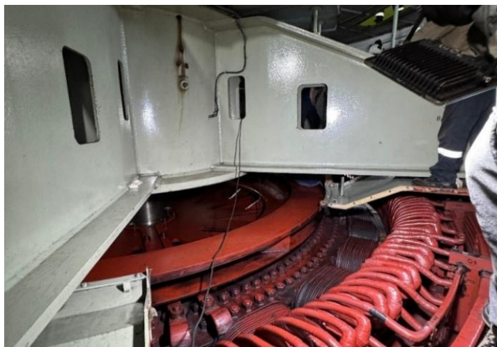
Figura 2: Conjunto estator-polos magnéticos de la central hidroeléctrica Acaray.
