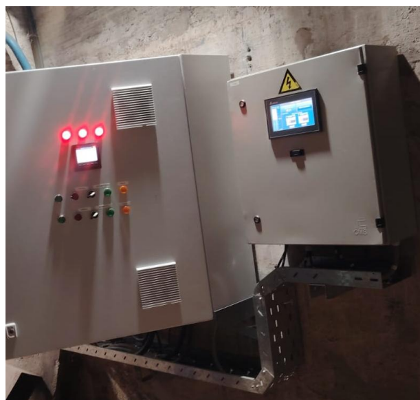
Figura 13: Sistema del centro de control de las bombas de la presa Acaray.
