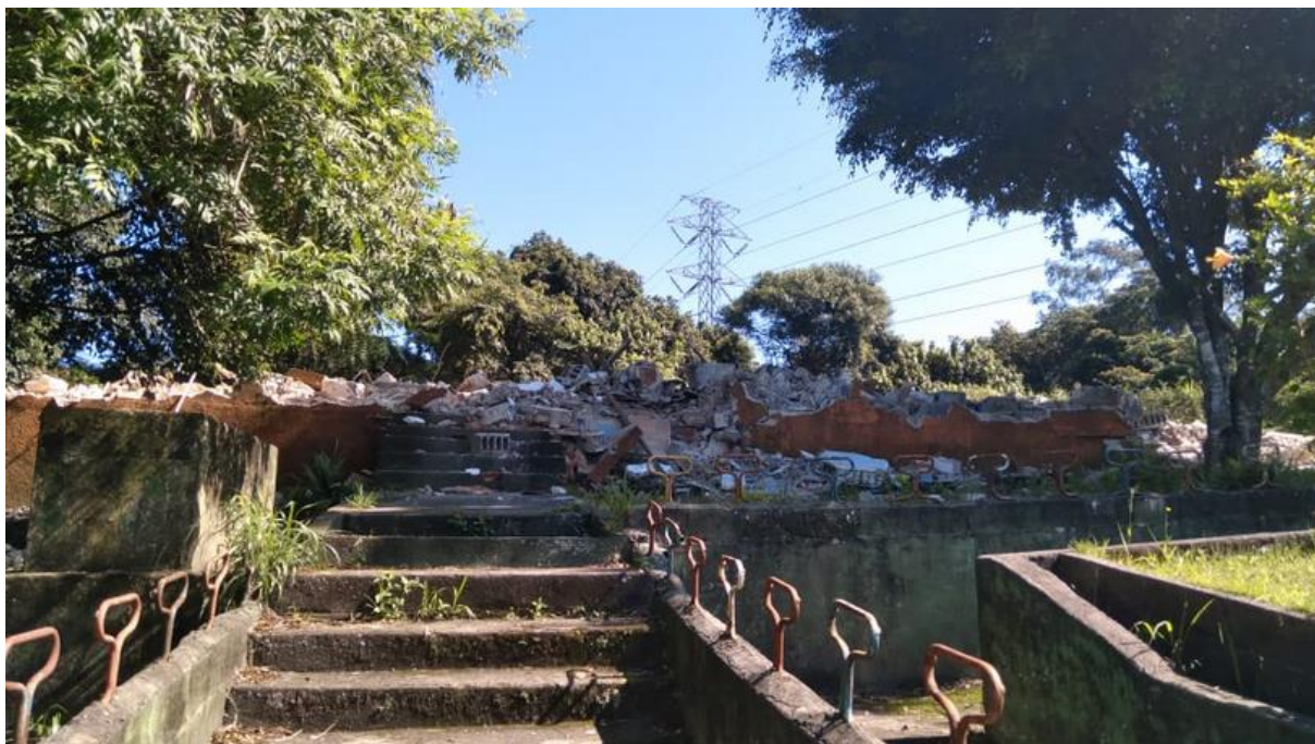
Figura 12 – Prédio da Ocupação Helenira Preta II depois da demolição, Mauá, SP (fonte: Heloisa Araújo/Comunicação do Movimento Olga Benário). Disponível em: http://www.labcidade.fau.usp.br/a-casa-helenira-preta-foi-demolida-quando-a-remocao-atravesa-a-vida-das-mulheres/
