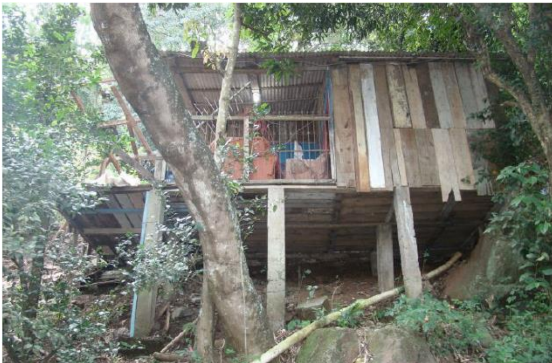
Figura 57 – Moradia vulnerável a deslizamento – Vila Bancária – Foz do Iguaçu/PR
