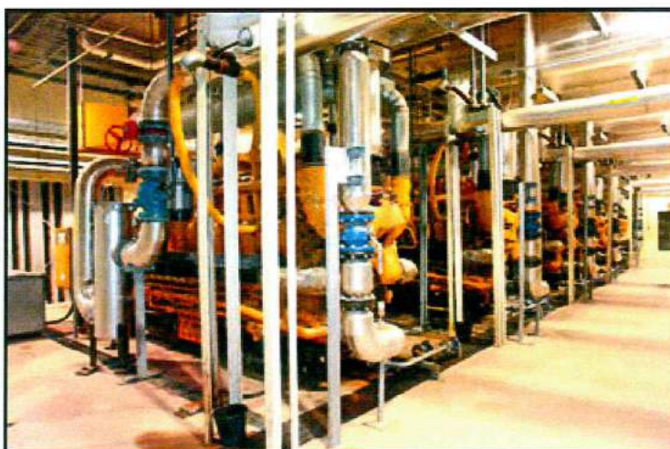
Figura 3: Motores a Combustão Interna - Aterro de São João
